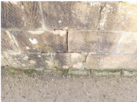
Mürbzone unterhalb der Mischkruste
