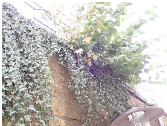
Pflanzenbewuchs in der Mauerkrone
