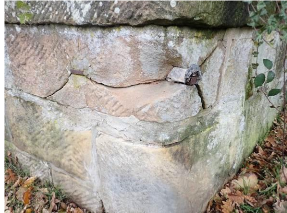
Steinschaden durch Korrosionssprengung
