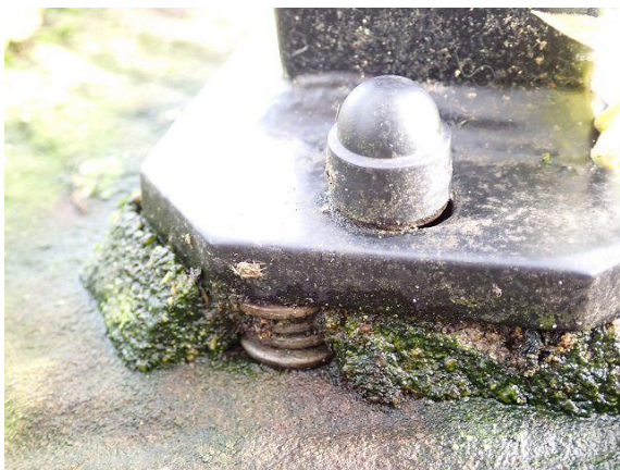
Zustand der Verankerung
