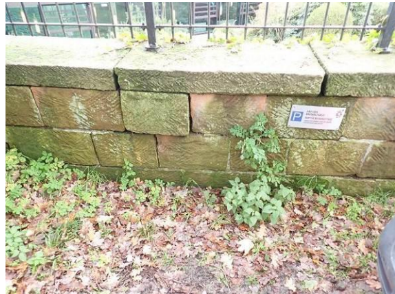
Gefügeschaden im Detail
