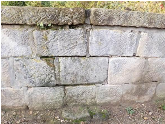
Gefügeschaden im Rissbereich
