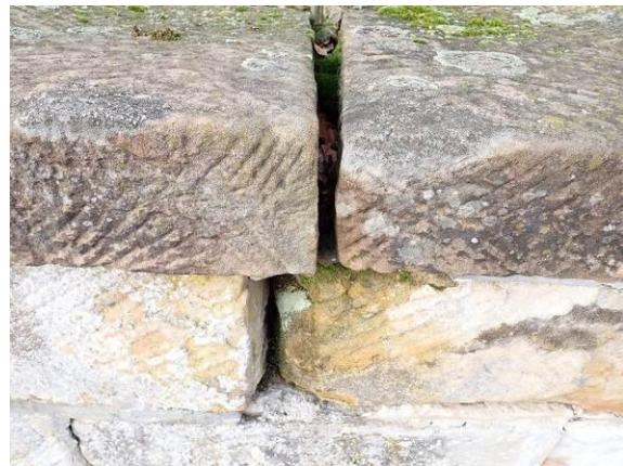
Rissbildung durch das Fugennetz
