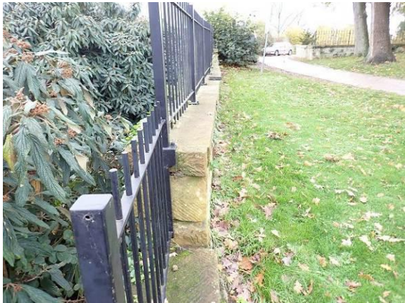
Teilansicht des verformten Wandbereiches
