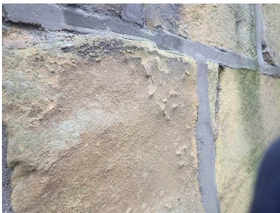
Oberflächenschäden durch gestörten Feuchtehaushalt
