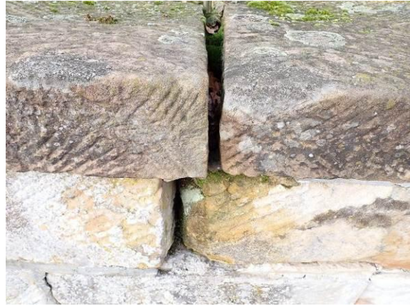
Abgängige Verfugung der Abdeckplatten
