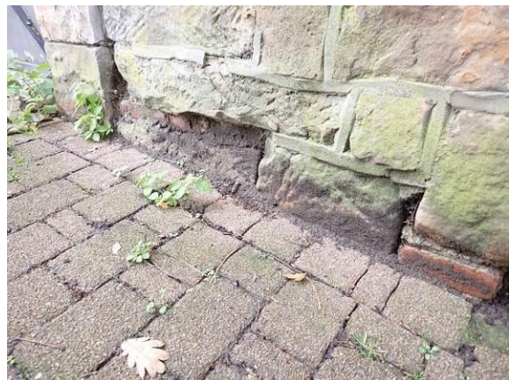
Schädigung in der Bodenwechselzone
