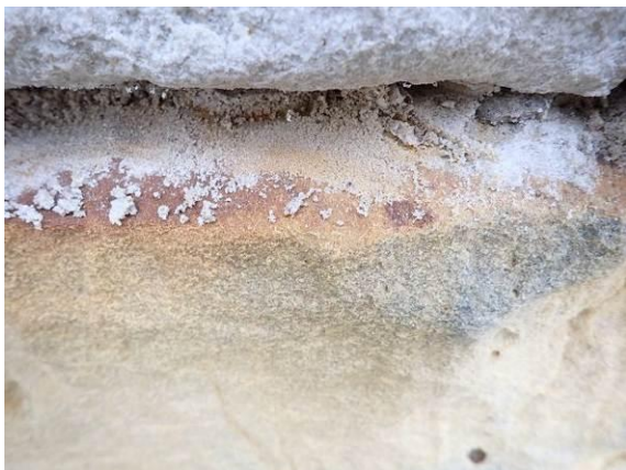
Einschwemmung von Sand im Verblendmauerwerk
