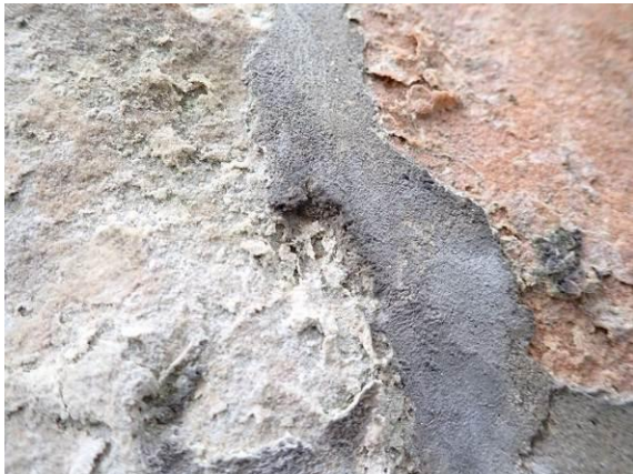
Steinschäden im Grenzbereich zu Zementfugen
