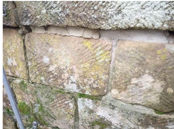
Schädigung des Setzmörtel der Abdeckplatten
