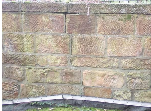
Entspannungsriss durch die Verformung
