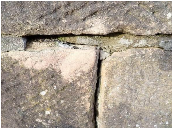
Zustand der zementösen Deckfugen
