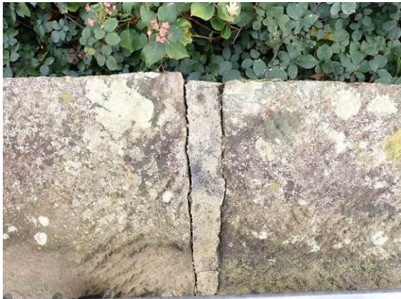
Zustand der Verfung der Abdeckplatten
