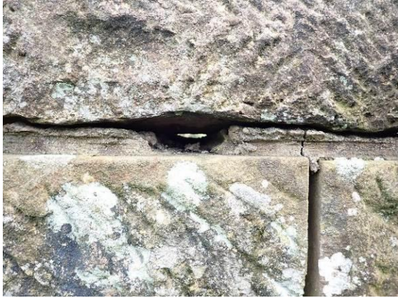
Zustand an der Attikaabdeckung
