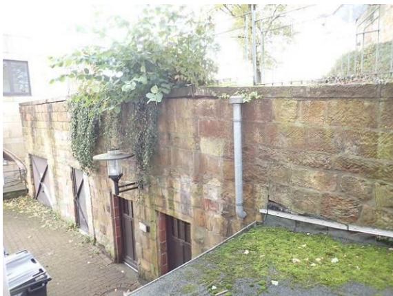
Buschwerk im Bereich der Mauerkrone
