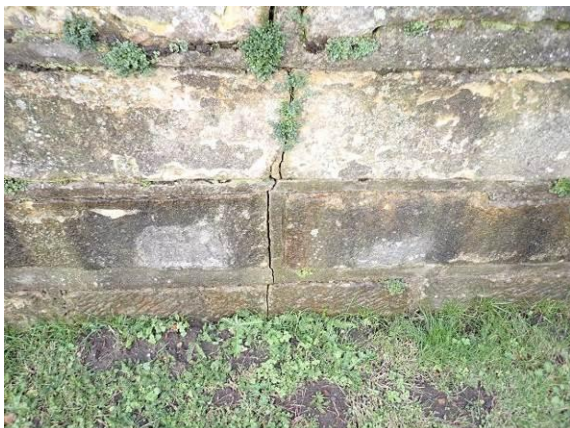
Rissbildung durch Verformung
