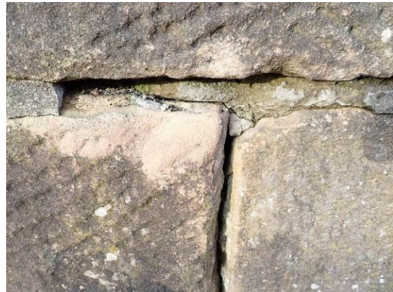
Zustand der Verfugung im Detail
