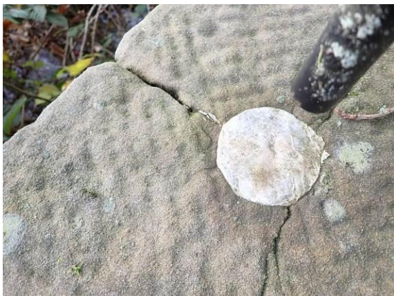
Steinsprengung durch ehemalige Zaunbefestigung
