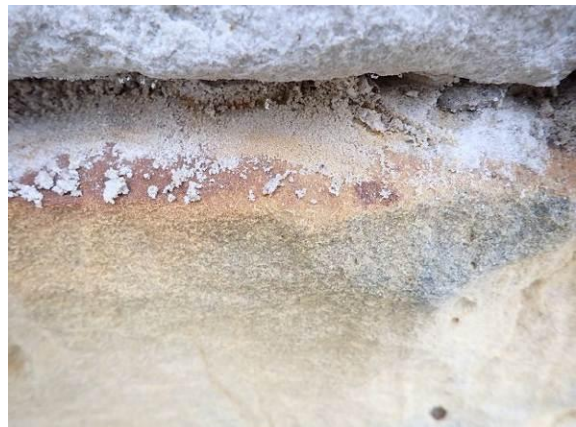
Sandeinschwemmungen im Detail
