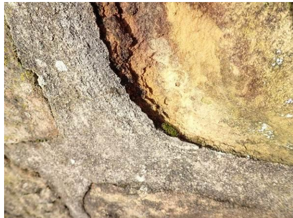
Steinverwitterung im Kontaktbereich zur Zementfuge
