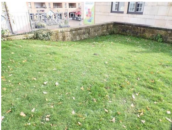
Wasserführung zum Attikamauerwerk
