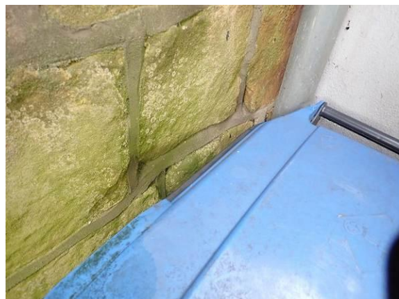
Biogener Bewuchs auf der Ostoberfläche
