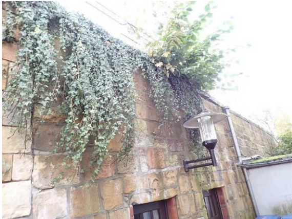
Bewuchs in der Mauerkrone
