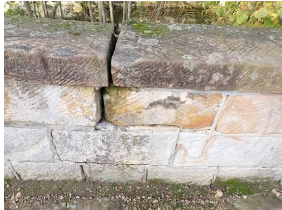
Bewuchs auf der Mauerabdeckung
