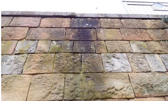
Bewuchs durch ungünstige Wasserführung
