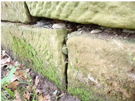
Gefügeschaden durch Wurzeldruck
