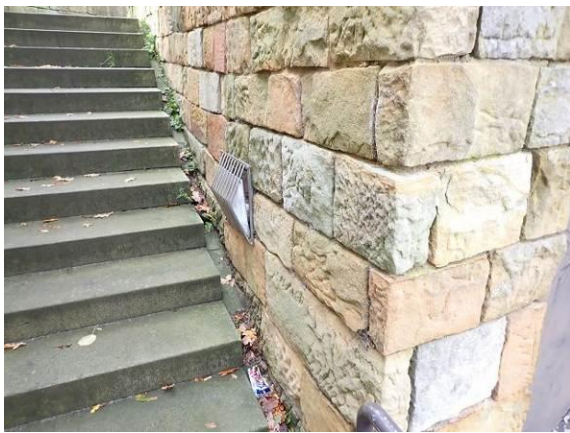
Verformung der Verblendschale
