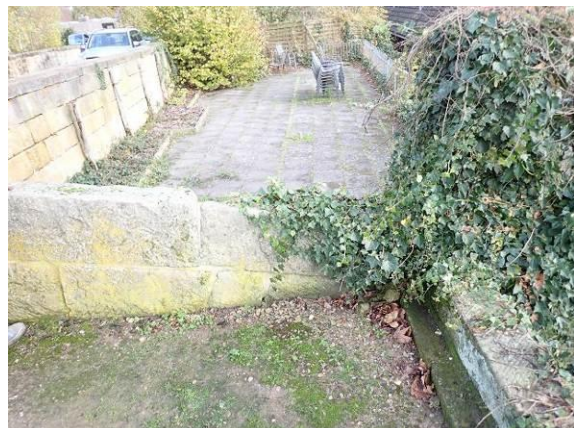
Efeubewuchs im Anschlussbereich
