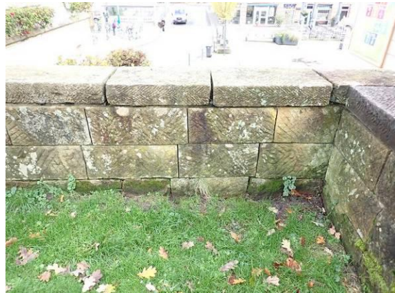
Zustand an der Mauerkronenausbildung
