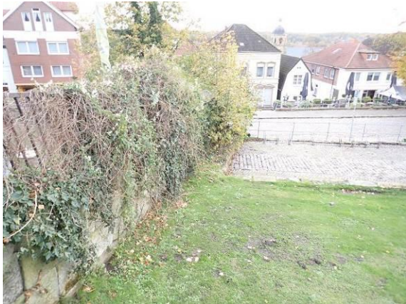
Bewuchs Einfriedungsmauer, Bahnhofstraße 111
