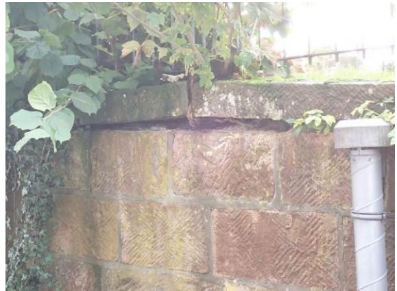
Schädigung durch Wurzeldruck
