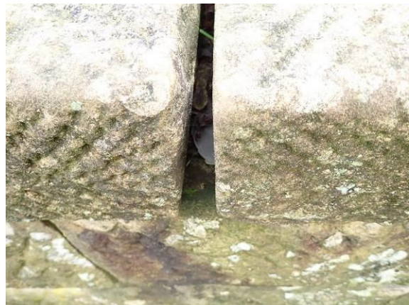
Offene Verfugung der Mauerabdeckung
