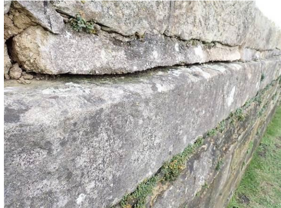
Rissbildung durch Verformung
