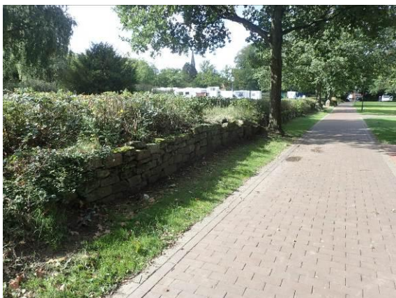
Bewuchs an der Südwand
