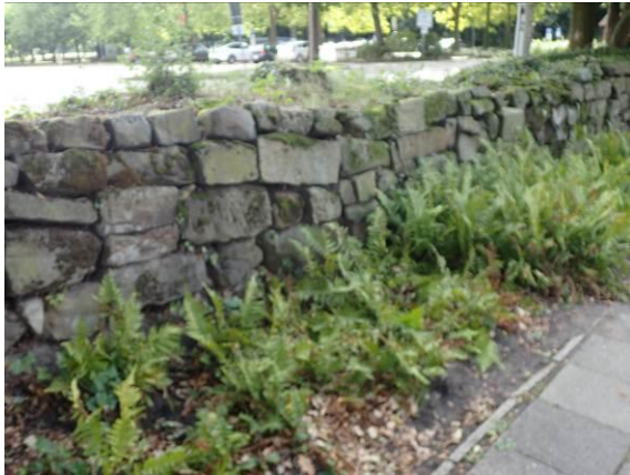
Gelöste Mauerkrone, Südwand
