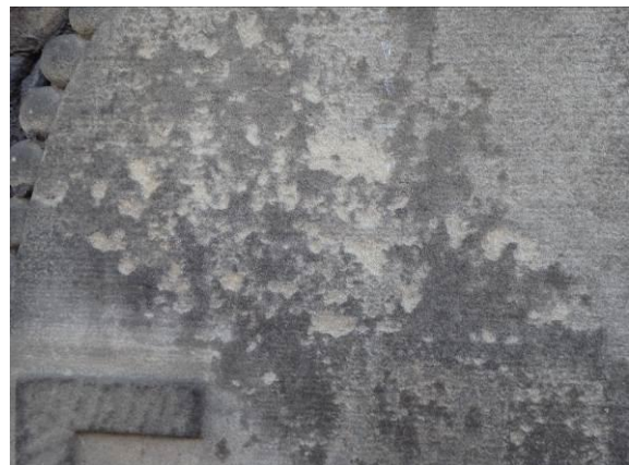
Dampfdruckschaden unter einer Mischkruste
