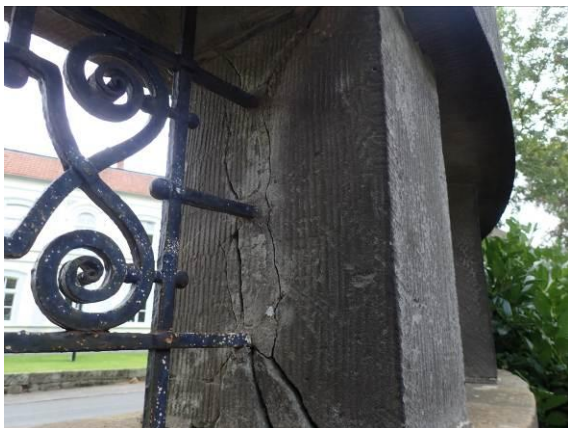
Steinsprengung an einer Vergitterung
