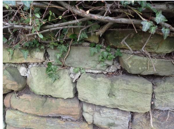
Efeu in der Mauerwerksstruktur
