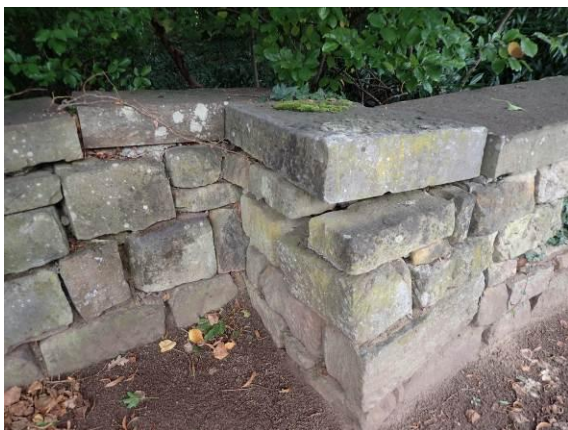
Verformte Mauerkrone, Ostwand
