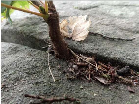
Bewuchs im Fugenbereich
