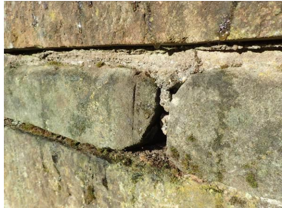
Geschädigtes Mörtelbett der Abdeckplatte
