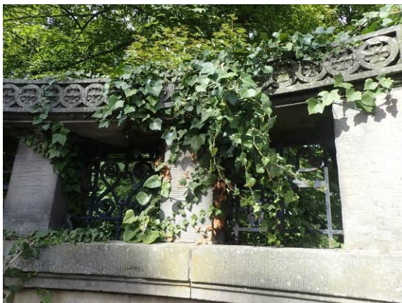
Efeubewuchs Flügelmauer, Osttor
