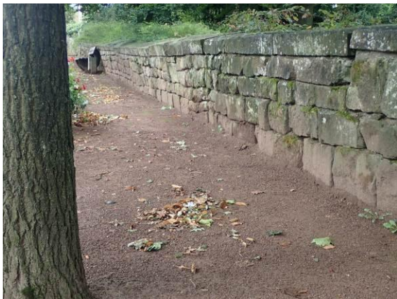
Verformung der Ostwand
