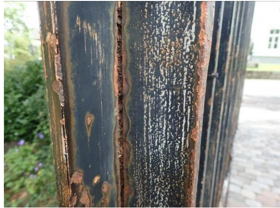
Korrosionsschäden am Tragprofil
