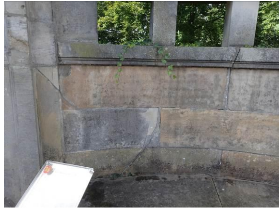
Rissbildung zur Flügelmauer
