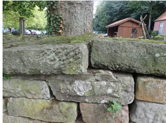
Gefügeschaden durch Wurzeldruck
