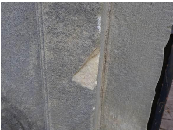
Schädigung durch Schalenbildung
