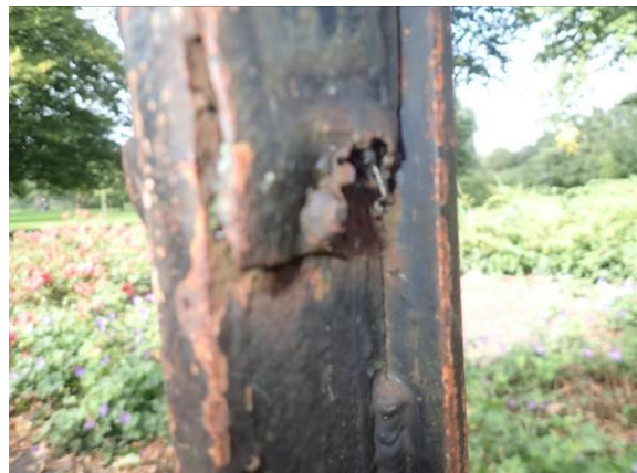
Weiterer Korrosionsschaden im Detail
