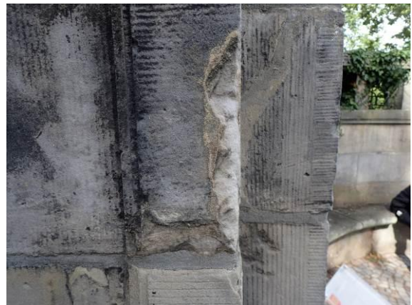
Steinschaden im Detail
