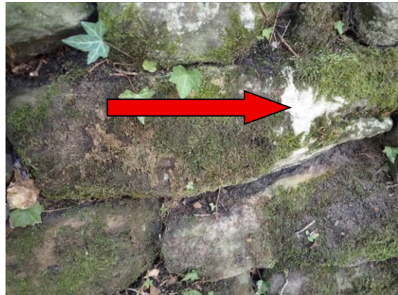
Steinschäden durch Bindemittelabbau
