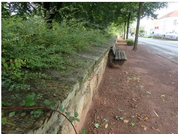
Verformung der Ostwand
