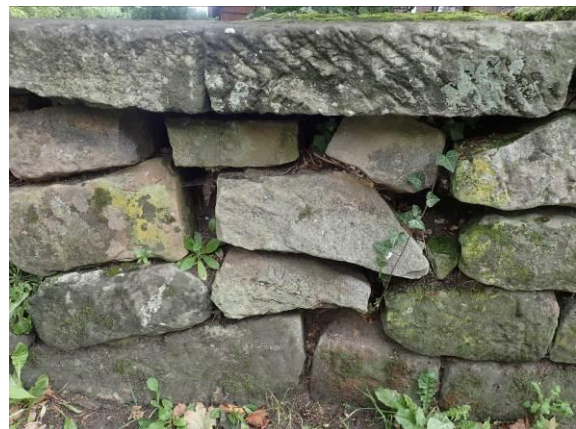
Gefügeschaden im Detail
