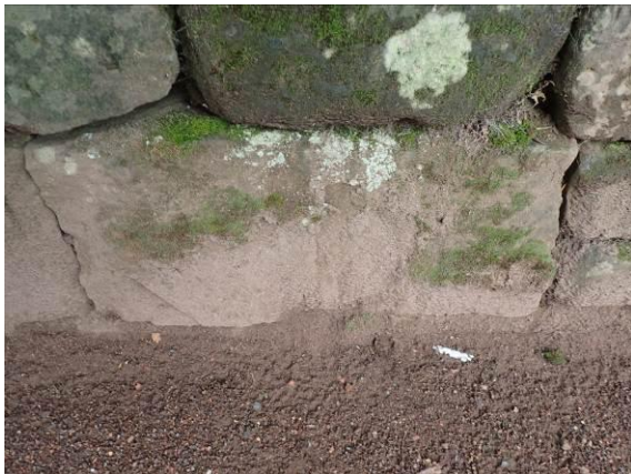
Oberflächenschäden im Spritzwasserbereich
