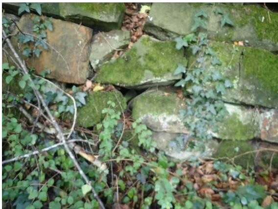
Zustand an der Südoberfläche
