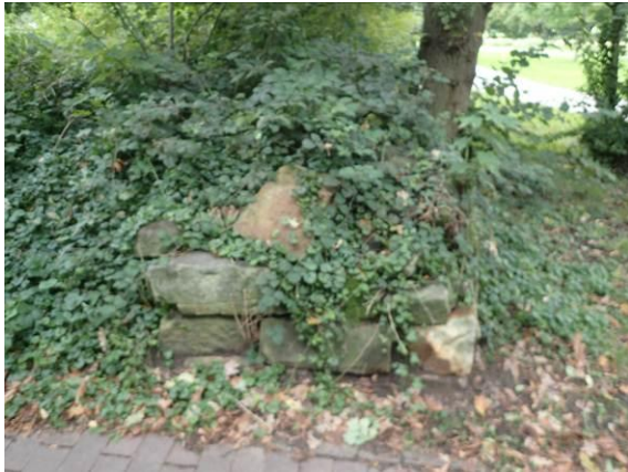
Bewuchs Mauerkrone Südwand
