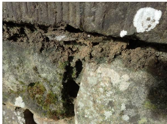
Wassereintrag durch fehlenden Überstand
