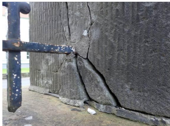
Korrosionssprengung im Detail
