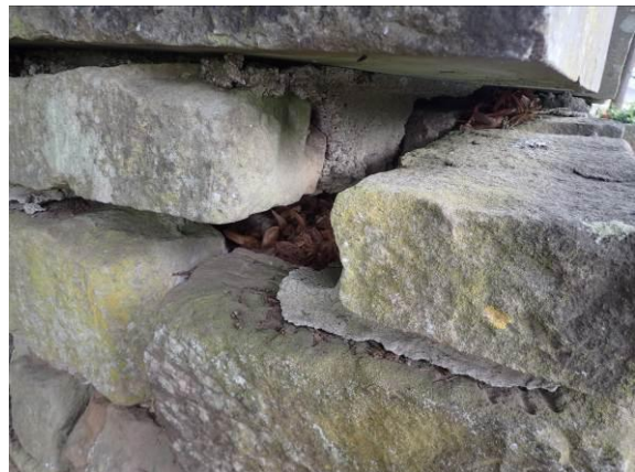
Gefügeschaden im Detail
