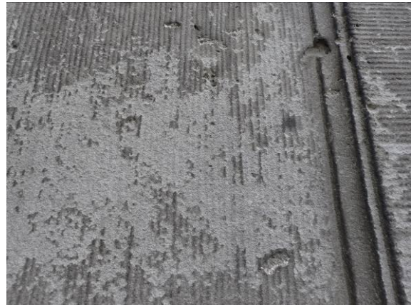
Oberflächenverlust an einer Scharrierung
