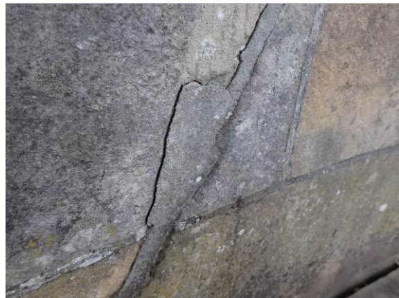
Zustand im Detail
