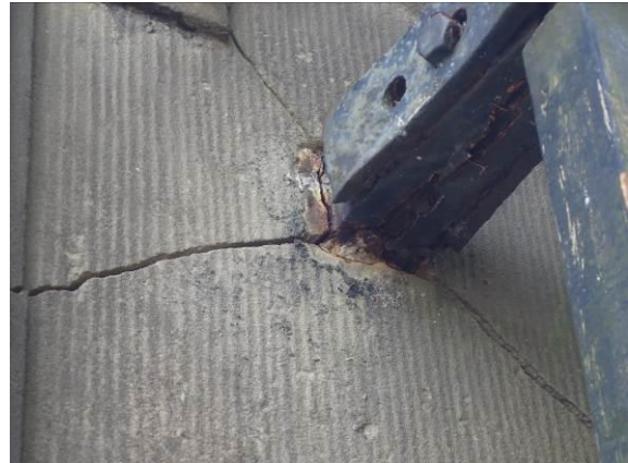
Korrosionssprengung im Detail
