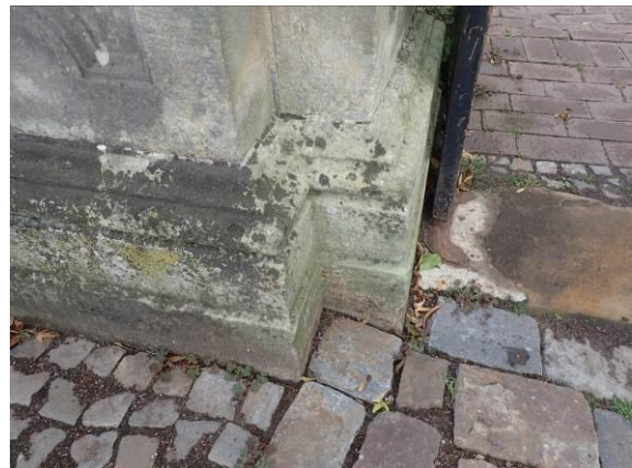
Schädigung im Schadsalzhorizont
