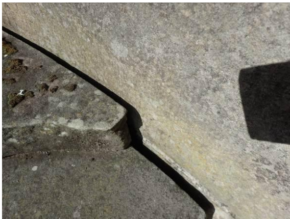
Verformung zur Sandsteinwand
