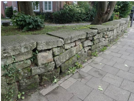
Verformung der Westwand
