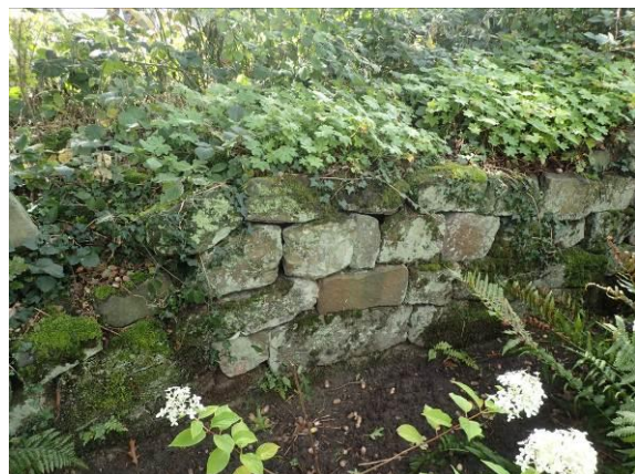
Zustand im Detail
