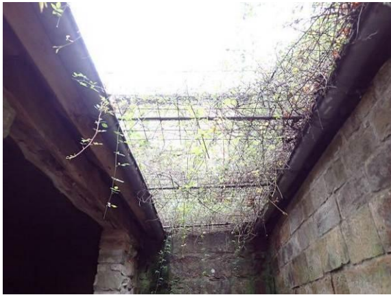
Entwässerung zwischen den Brunnenhäusern
