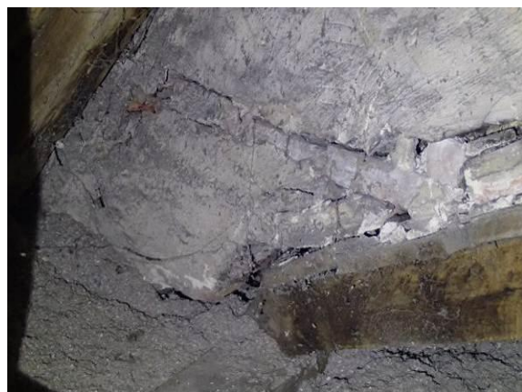
Gefügeschaden am unteren Ansatz
