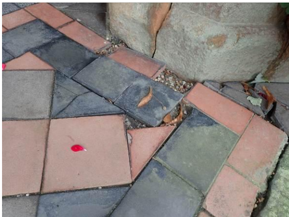
Zustand im Detail
