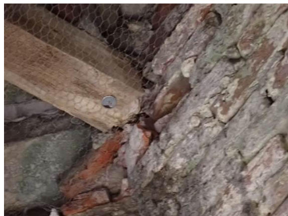
Schädigung im Auflager
