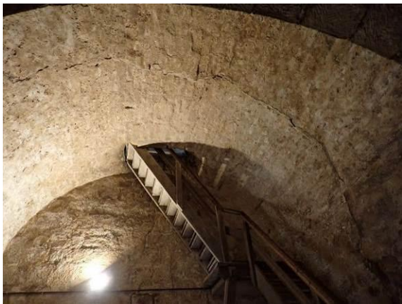
Rissbildung im Tonnengewölbe
