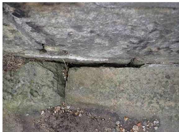
Absenkung im Detail
