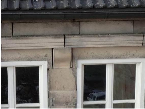
Zustand oberer Wandbereich Ostfassade
