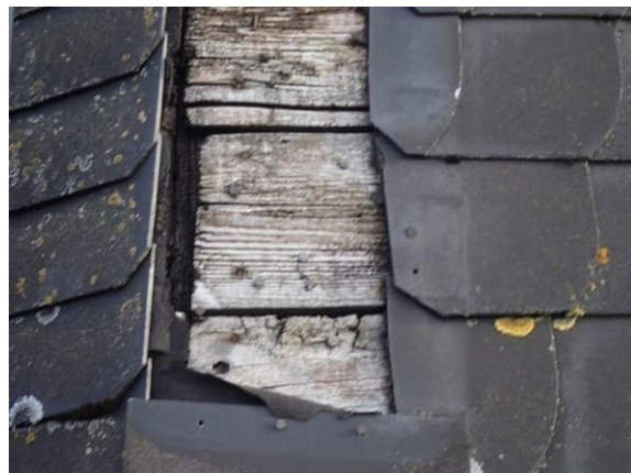
Feuchteeintrag ins Dachtragwerk
