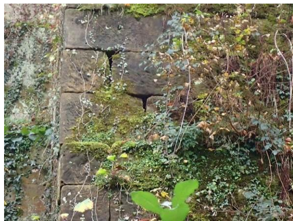
Lockerung an der Nordostecke
