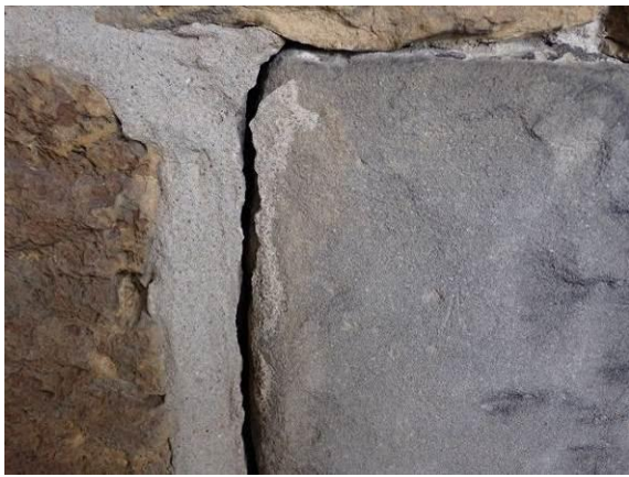
Separierung durch Rissbildungen
