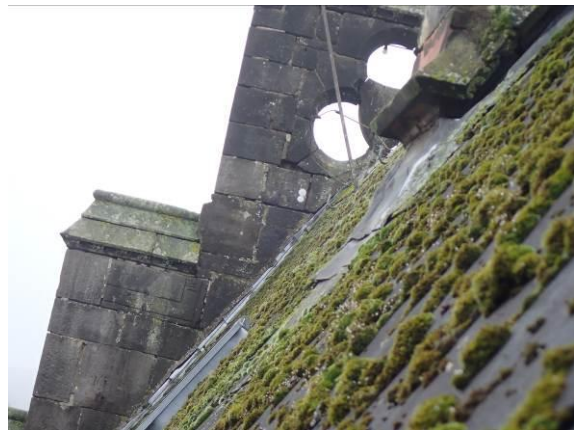
Bewuchs an der Norddachfläche des Südflügels
