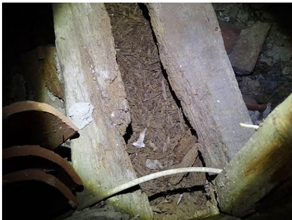
Zustand im Detail
