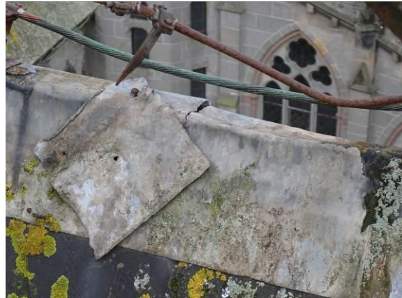
Zustand im Detail
