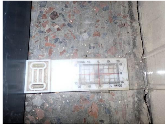
Rissmonitor im Detail
