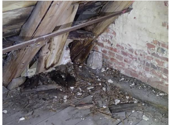
Schädigung am Schornsteinanschluss Nordwest
