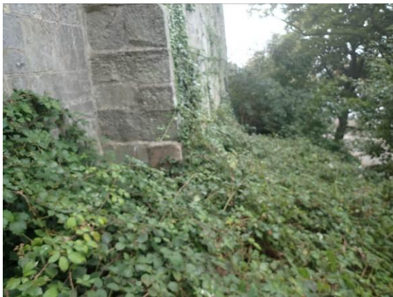
Bewuchs Sockel der Nordfassade
