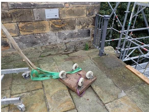
Verformter Bodenbelag am Pulverturm
