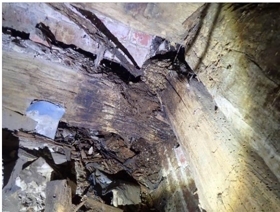
Schädigung am Kehlenfuß Südwest
