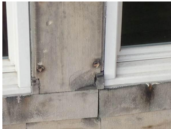
Ausbrüche durch Verformung
