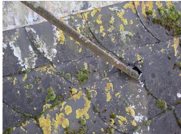
Abgängige Eindichtung in die Dachhaut
