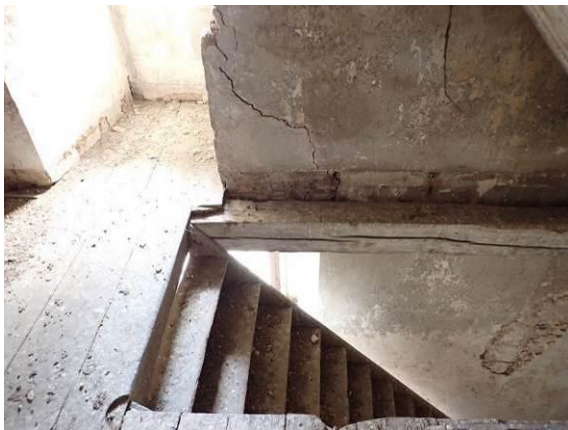
Gefügeschaden im Laibungsmauerwerk
