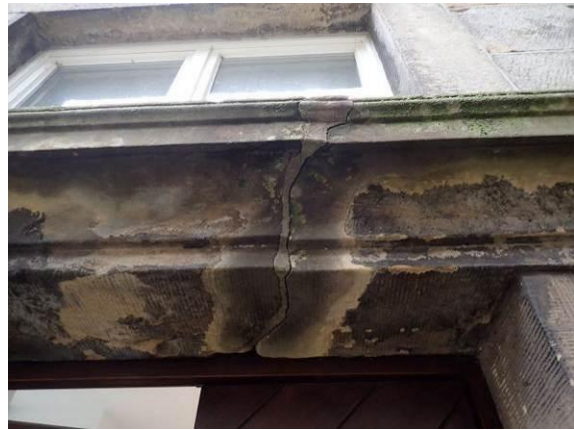
Zustand im Detail
