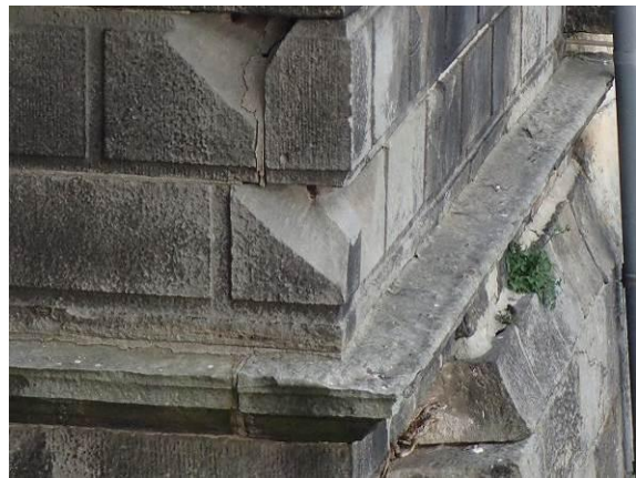
Ausbrüche im Detail
