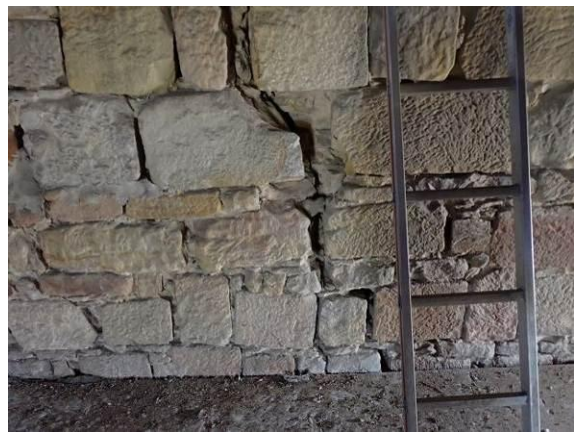
Rissbildung im Detail
