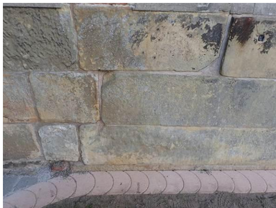
Rissbildungen in den erneuerten Fugen
