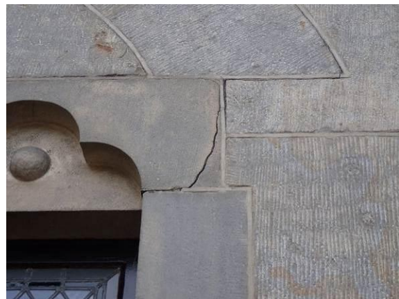
Rissbildung im Sturzriegel
