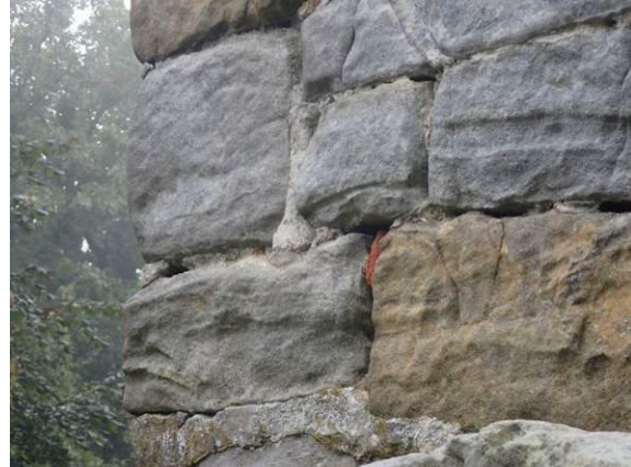
Weitere geschädigte Verfugung
