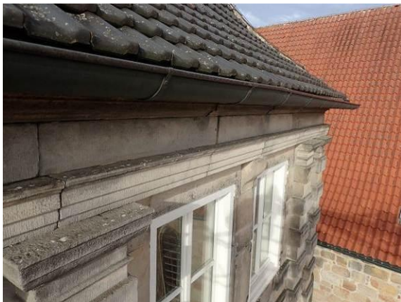
Verformung östliches Traufgesims
