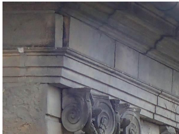
Verformung westliches Traufgesims
