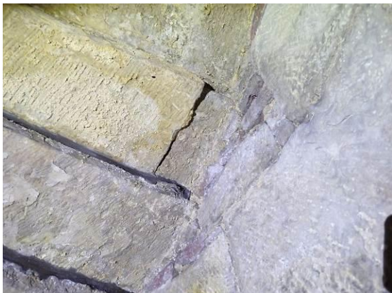
Weitere Bruch einer Blockstufe
