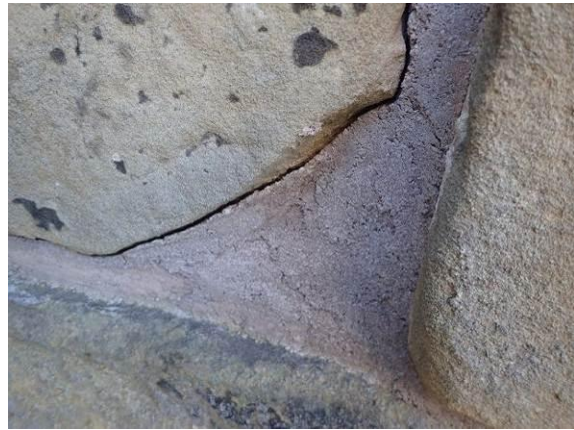
Erneutes Ausbrechen der Außenschale
