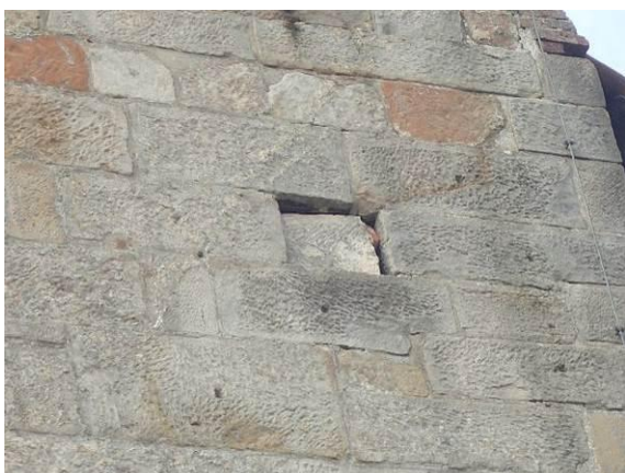
Lockerung in der Ostfassade
