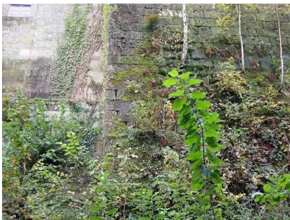
Bewuchs Sockel Nordfassade
