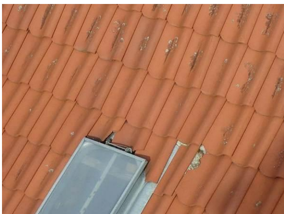
Schädigung am Dachfenster
