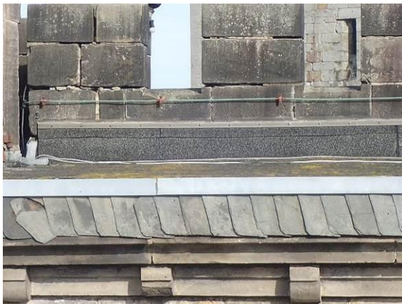
Gefügeschaden im Detail
