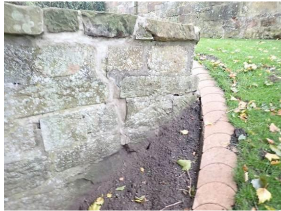
Verformung im Detail
