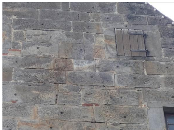
Rissbildung im Detail
