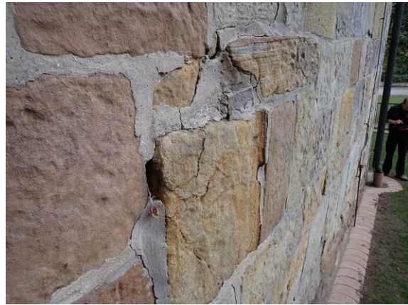
Verformung im Detail
