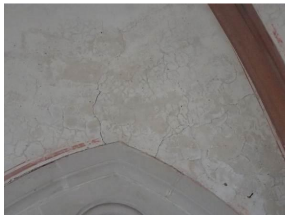
Erhöhte Bauteilfeuchte in den Wiederlagern
