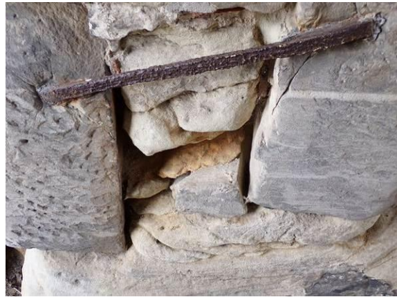
Zustand im Detail
