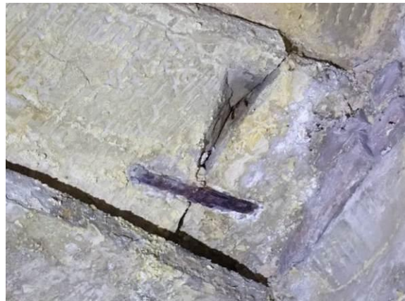
Reparaturversuch an einer Blockstufe
