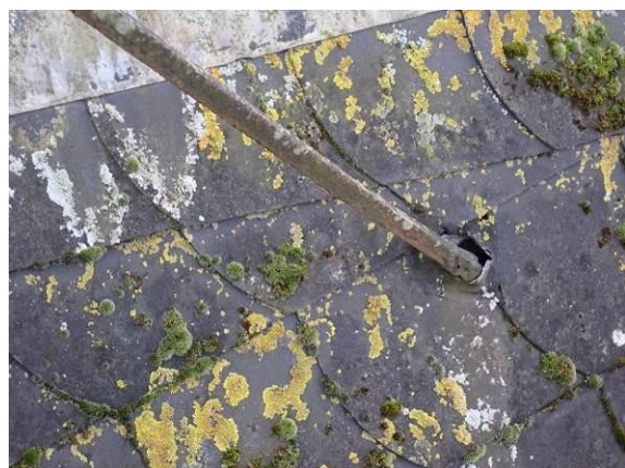
Fehlende Eindichtung eines Giebelankers
