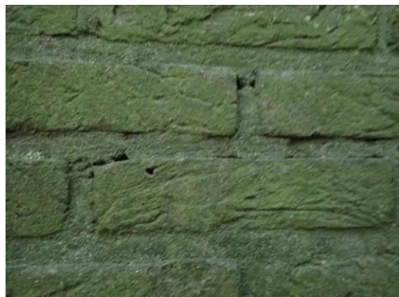
Zustand im Detail
