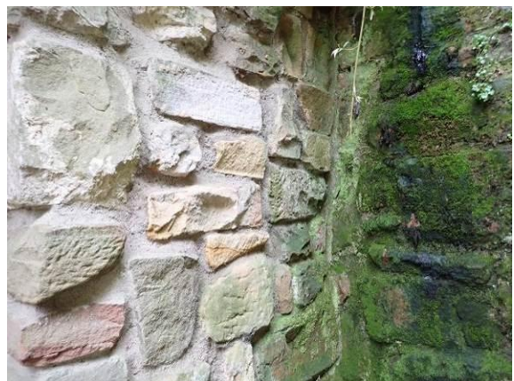
Zustand im Detail
