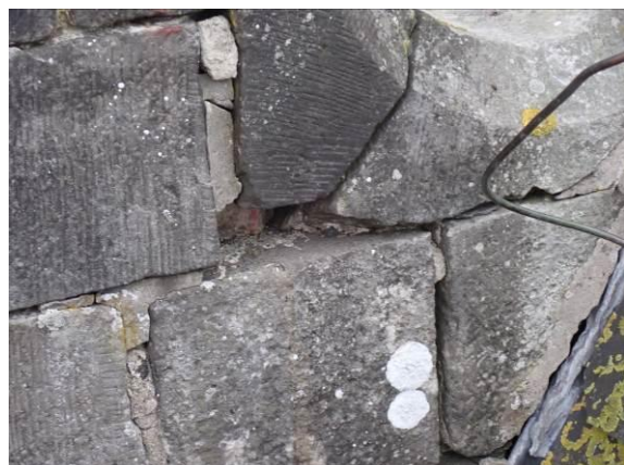
Zustand im Detail
