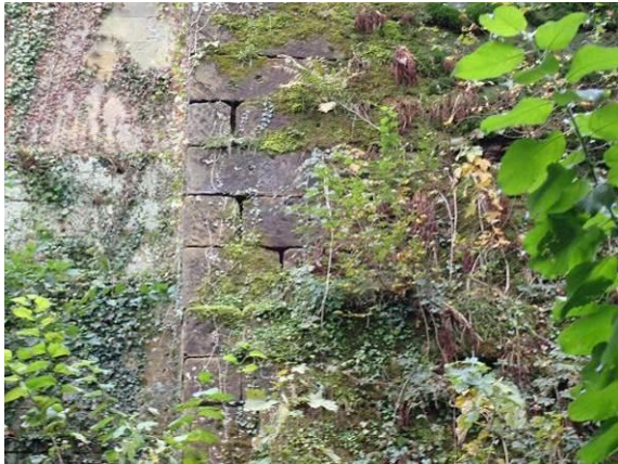
Fehlende Verfugung, Nordfassade
