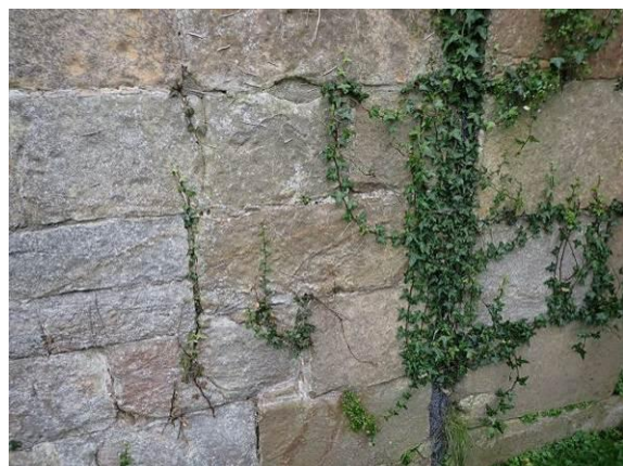
Efeubewuchs im unteren Bereich der Westfassade
