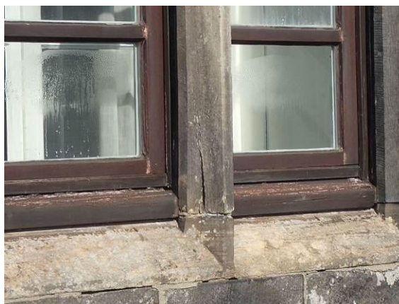
Korrosionssprengung im Detail
