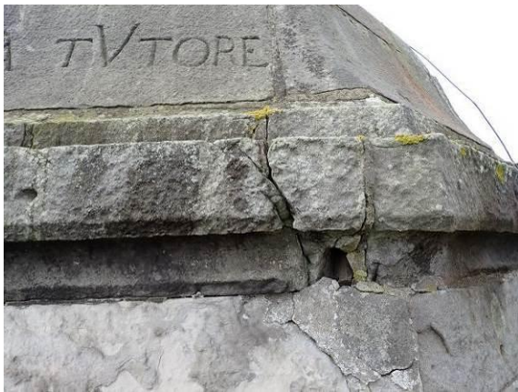
Steinsprengung am Gesimsbalken
