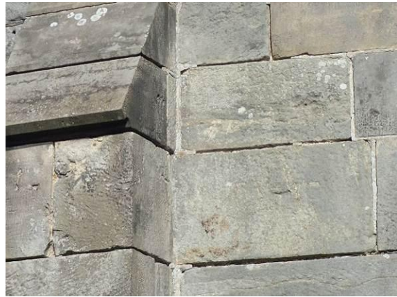
Fugenschäden im Detail
