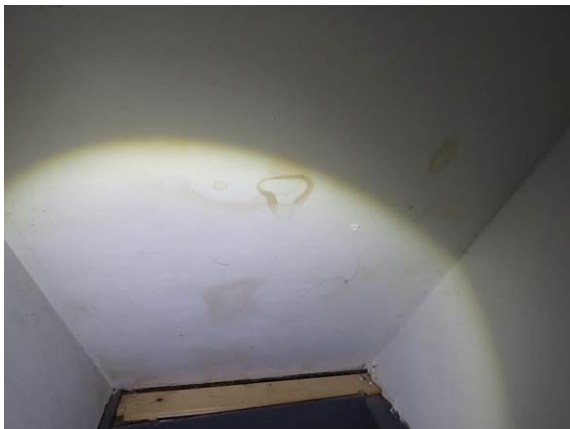
Folgeschaden am Innenausbau
