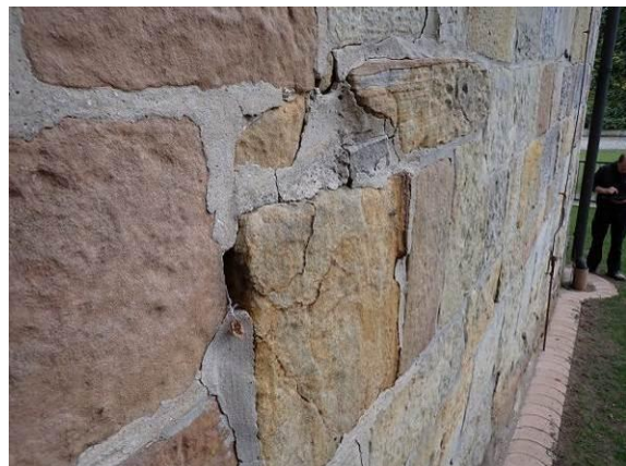
Schädigung im Detail
