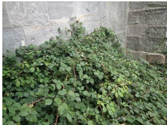
Zustand im Detail
