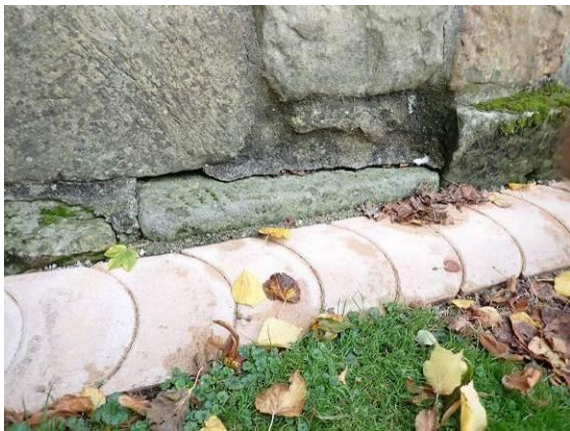
Schädigung in der Bodenwechselzone
