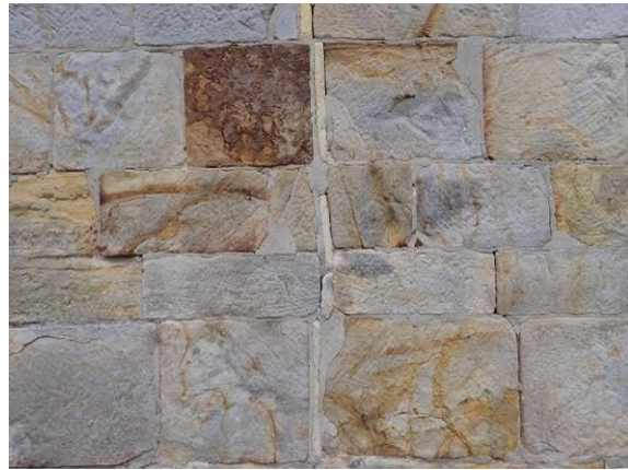
Rissbildung im Brüstungsbereich
