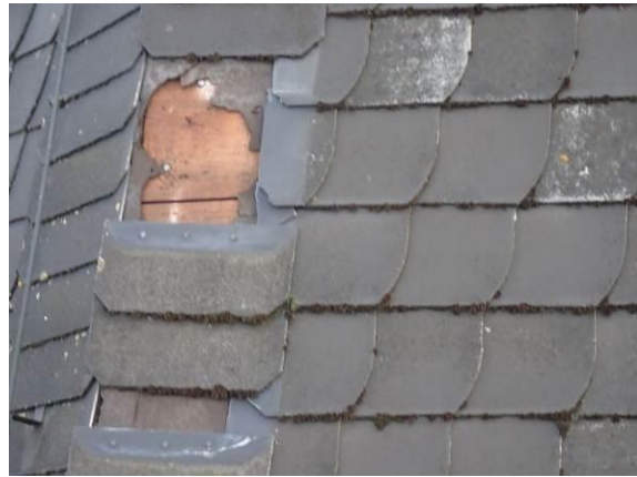
Fehlende Platten am Grat
