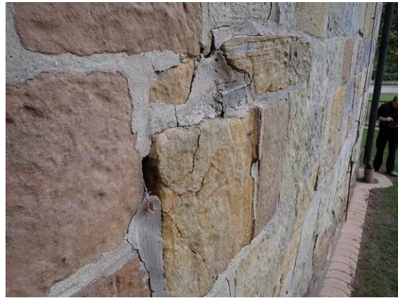
Verformung im Detail
