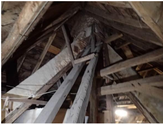
Fehlende Eckabstützung Walmpfette Ost
