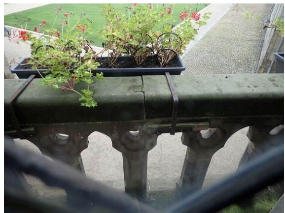
Bewuchs am Brüstungsgurt
