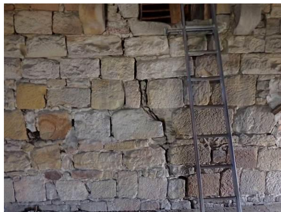
Verformung im Detail
