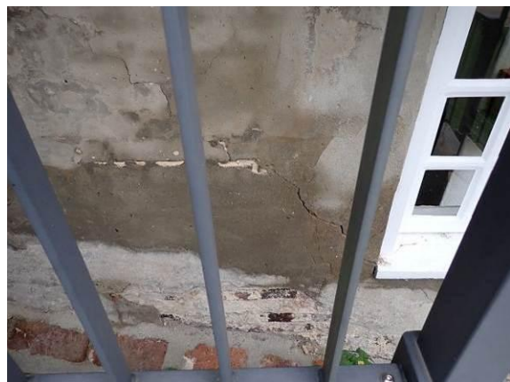
Folgeschaden an der Traufwand
