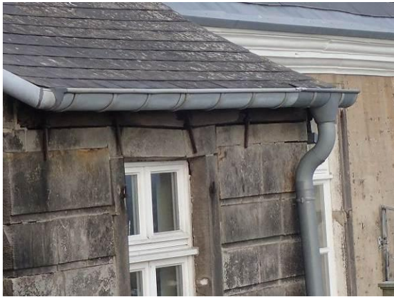
Verformte Maueranker am Süderker
