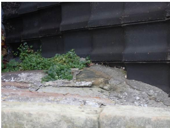
Verformung Außenschale im Detail
