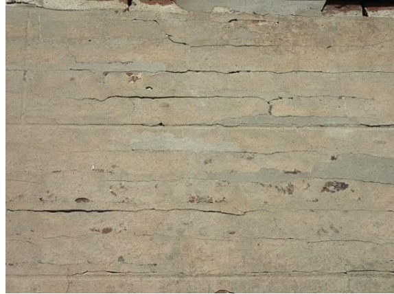
Abzeichnen der Lagerfugen durch Verformungen
