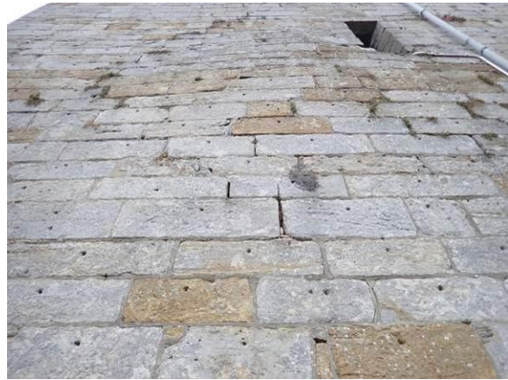
Verformung im Zentralbereich
