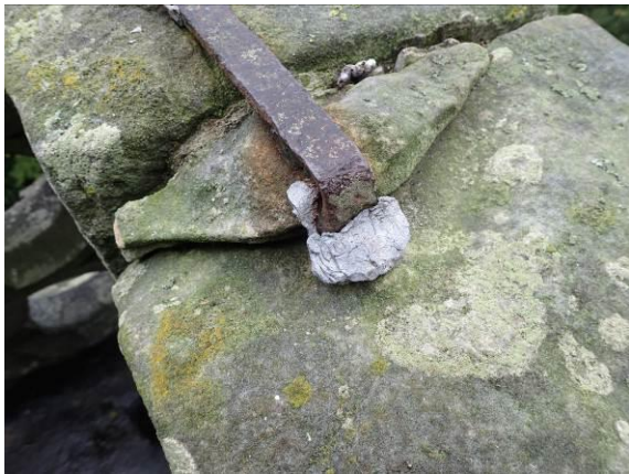
Steinausbruch an einer Klammer
