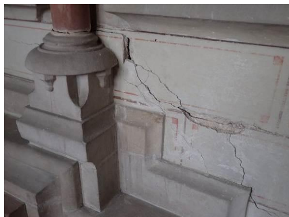
Verformung im Brüstungsbereich
