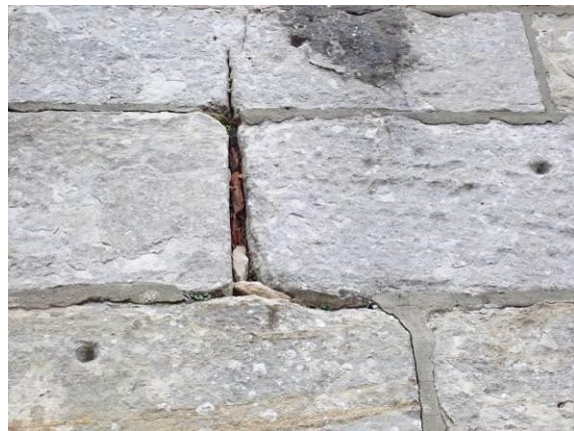
Abgängige Fuge mit gelösten Zwickelsteinen
