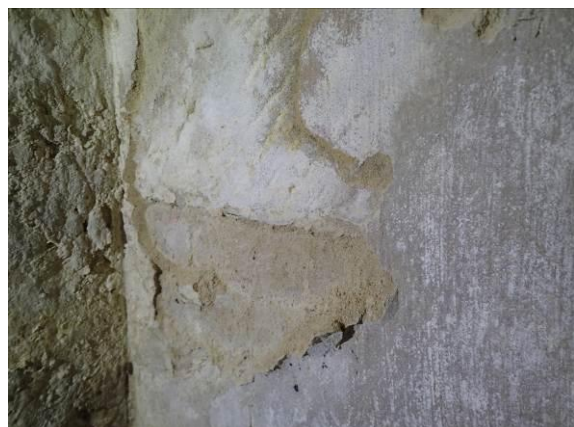
Zustand im Detail
