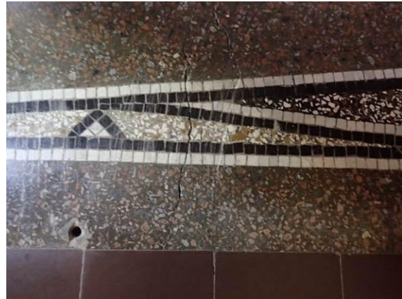
Schädigung im Detail
