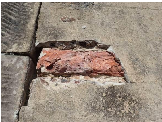
Fehlstelle im Detail
