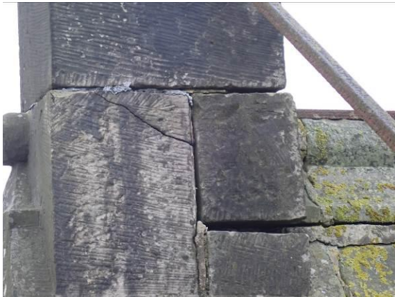
Korrosionssprengung am Staffelgiebel
