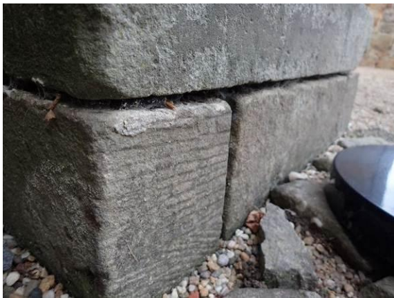
Abgängige Verfugung an einer Zinne
