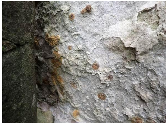
Oberflächenverlust durch Schalenbildungen
