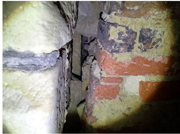
Zustand im Kernmauerwerk
