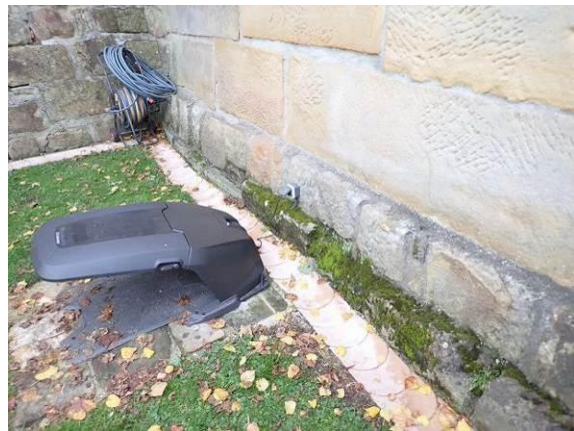
Folgeschaden im Sockelbereich
