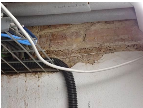
Weitere Befallsspuren am Deckenbalken
