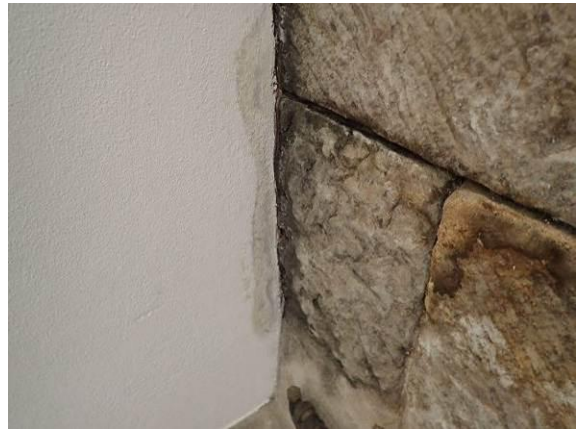
Feuchteintrag im Detail
