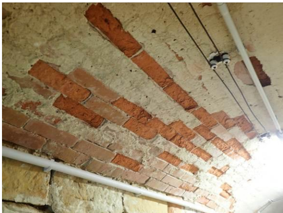
Dampfdruckschäden an Strangpressziegel
