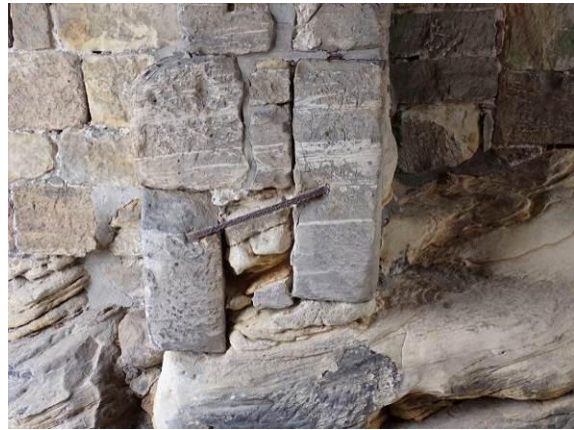
Zustand im Detail
