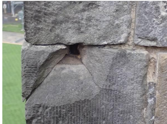
Ausbrüche im Detail
