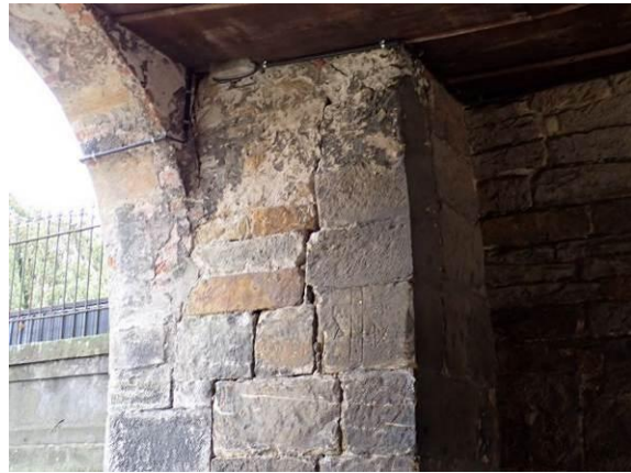
Ablösung der Innenschale
