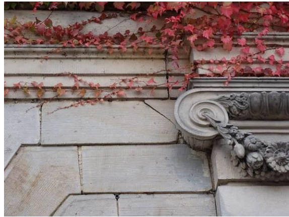
Steinschäden durch Verformung des Bogens
