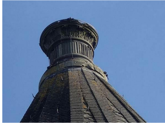
Zustand im Detail
