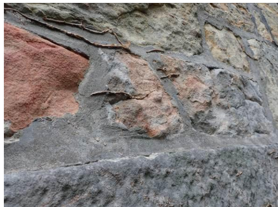
Steinschäden im Anschluss zu Zementfugen
