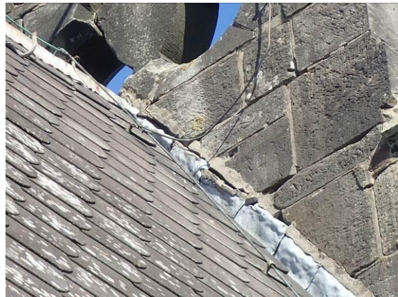
Zustand im Detail
