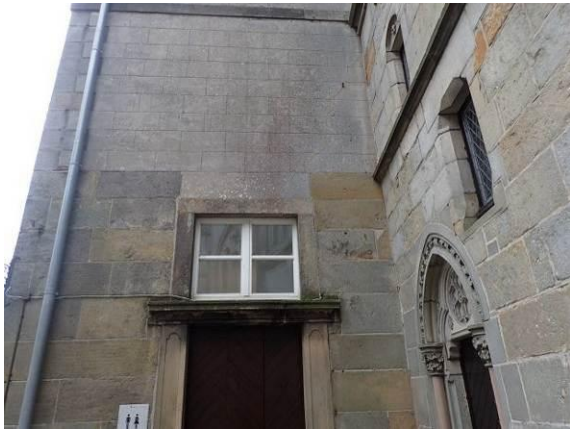
Sturzriegel am Eingang West
