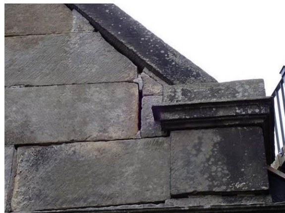
Zustand der Deckfugen im Detail
