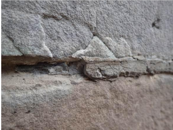
Geschädigte Deckfuge im Detail
