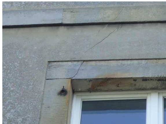
Rissbildung im Gewände
