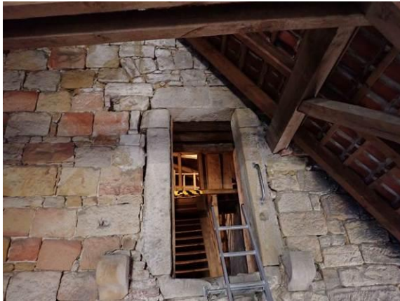
Gefügeschaden im oberen Wandbereich
