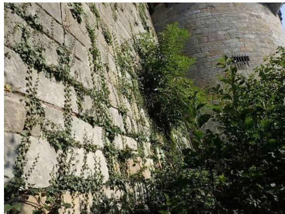
Efeubewuchs im Fugennetz
