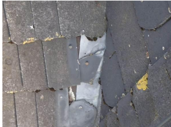
Geschädigte Kehle; Kronenburg
