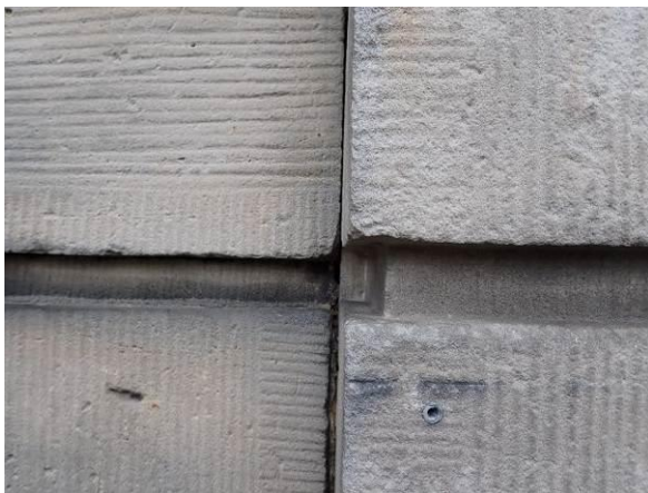
Verschiebung im Stoßfugenbereich
