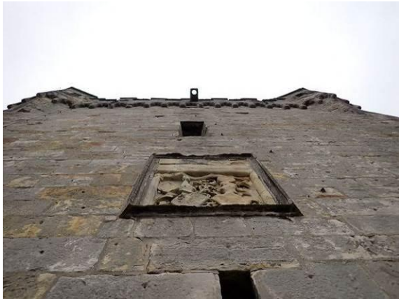
Entwässerung oberhalb der Wappentafel
