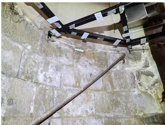
Bindemittelauswaschungen, Nordwand, Treppenhaus
