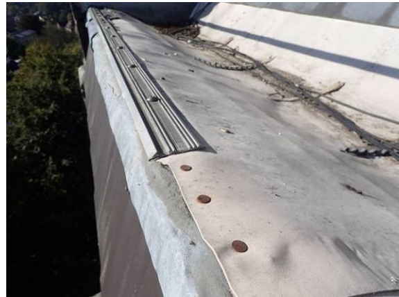
Zustand im Detail
