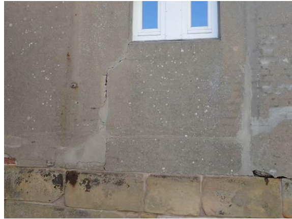
Rissbildung an Baunähte
