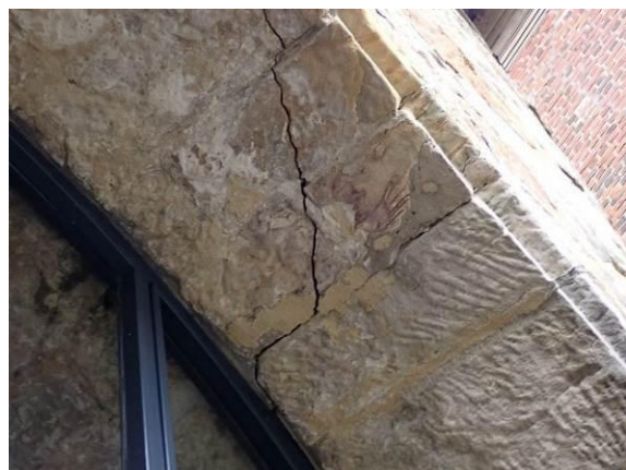
Rissbildung aufgrund von Schalenablösungen
