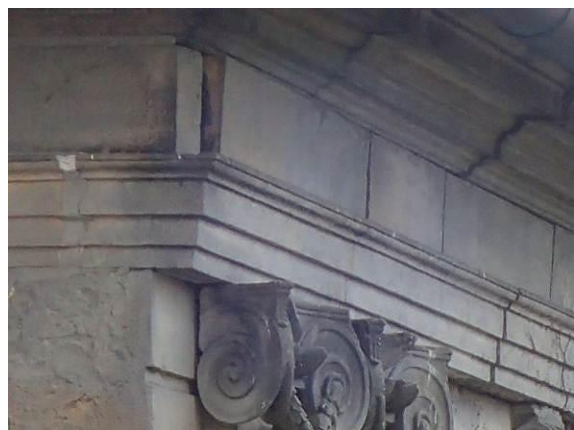
Gefügelockerung Traufgesims West
