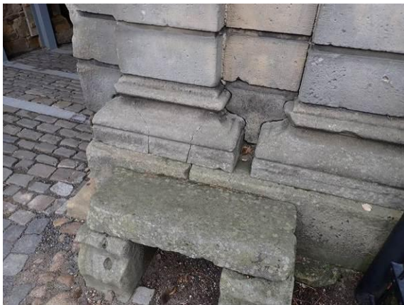
Steinschäden durch ungleichmäßige Belastung
