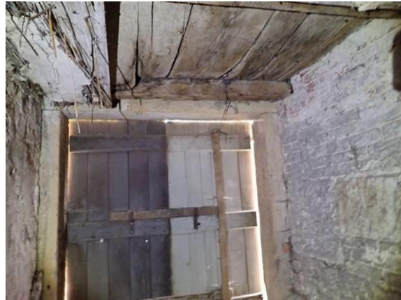
Geschädigte Fensterläden, Nordflügel, Kronenburg
