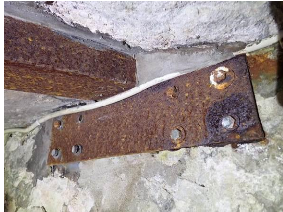
Zustand im Detail
