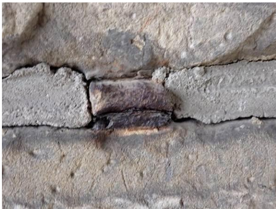
Korrosionssprengung im Detail
