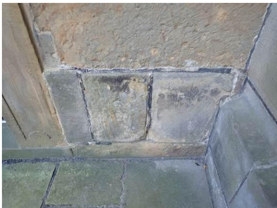
Zustand der Verfugung im Sockelbereich
