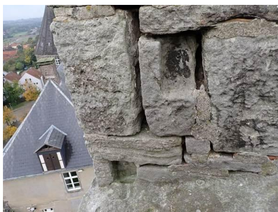
Gefügeschaden in einer Zinne
