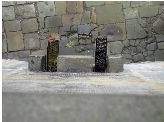
Zustand der Abflüsse
