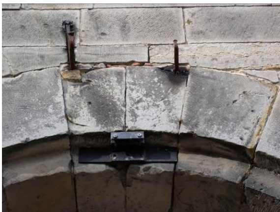
Durch Korrosion geschädigter Schlussstein
