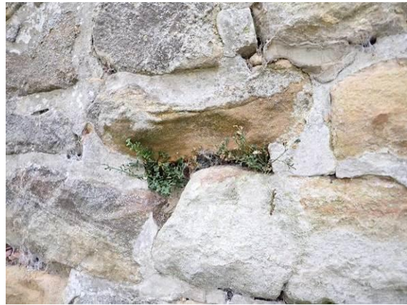
Fugenschaden im Detail
