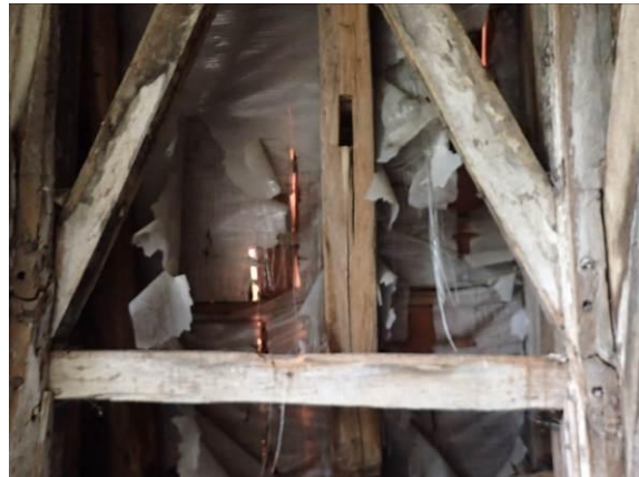
Zustand im Detail
