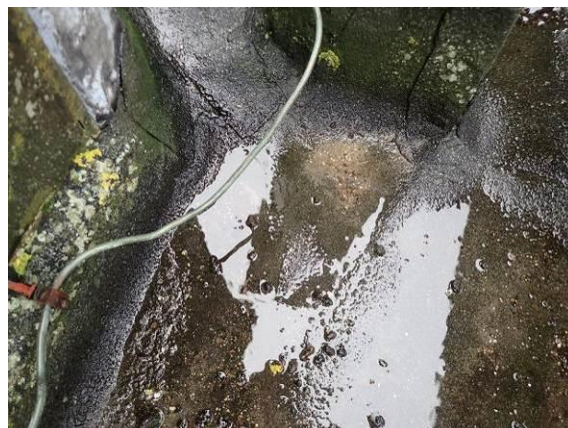
Zustand im Detail
