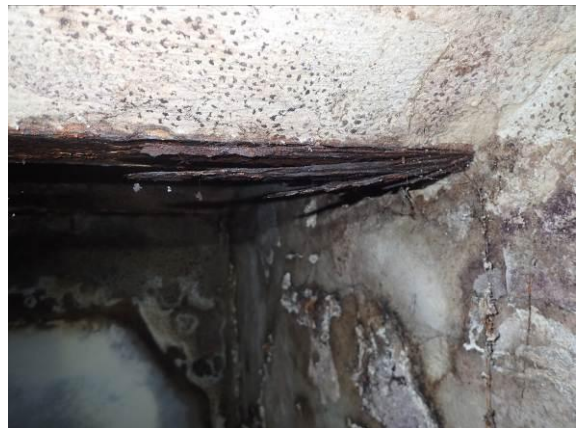
Schädigung im Auflager
