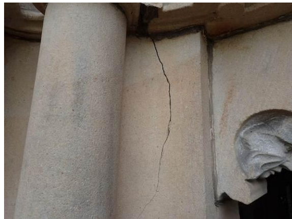
Steinschaden im Auflagerbereich
