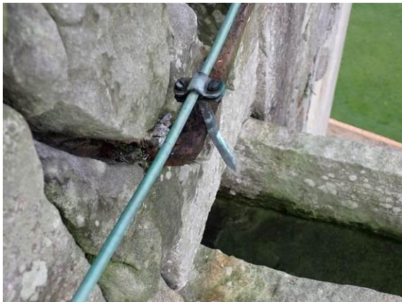
Gelöste Verankerung am Pulverturm
