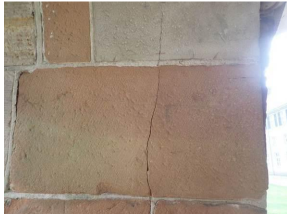
Rissbildung im Detail
