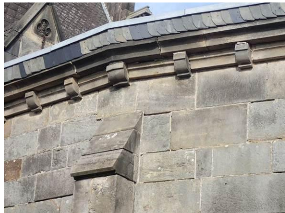
Geschädigte Verfugung der Westfassade
