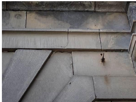
Bruch Gesimsband durch das Einsinken des Bogens
