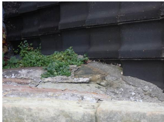
Folgeschaden im Detail
