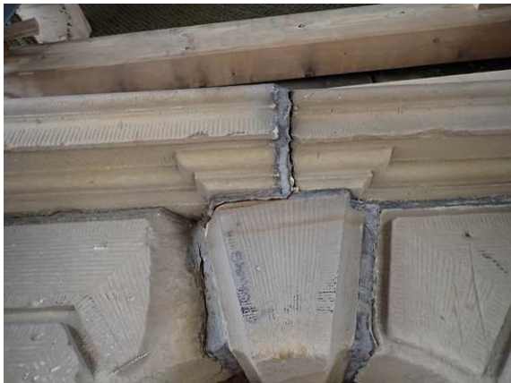
Verformung am Gewände
