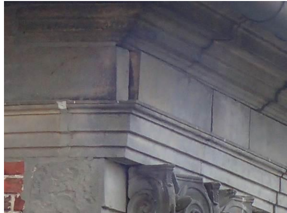
Zustand im Detail
