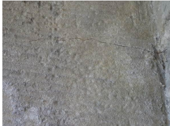
Rissbildung in den Kragsteinen
