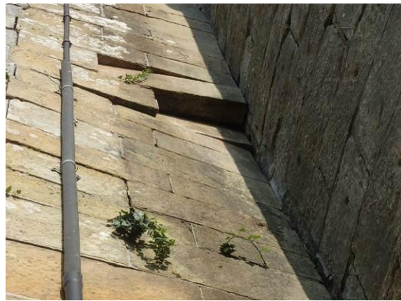
Zustand im Detail
