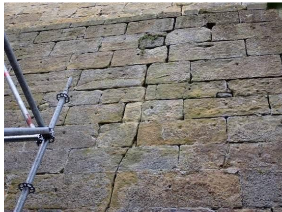
Rissbildung in der Nordfassade
