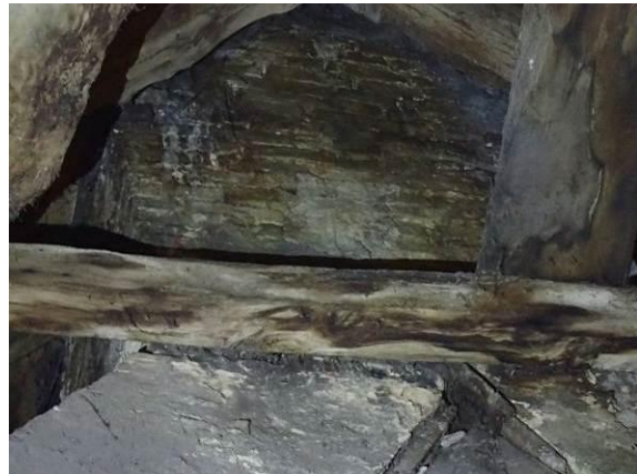
Versottung im Dachgeschoss
