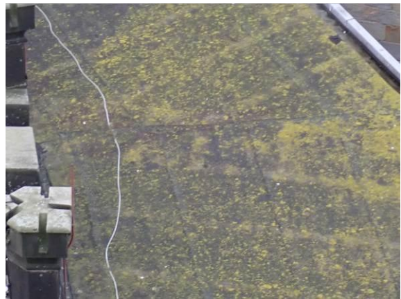
Zustand im Detail
