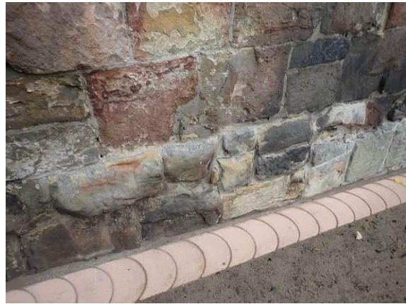
Zustand im Detail
