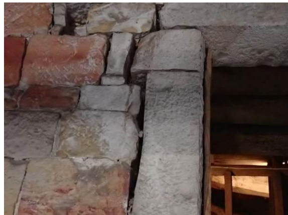
Zustand im Detail
