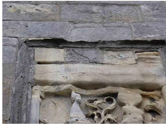
Zustand im Detail
