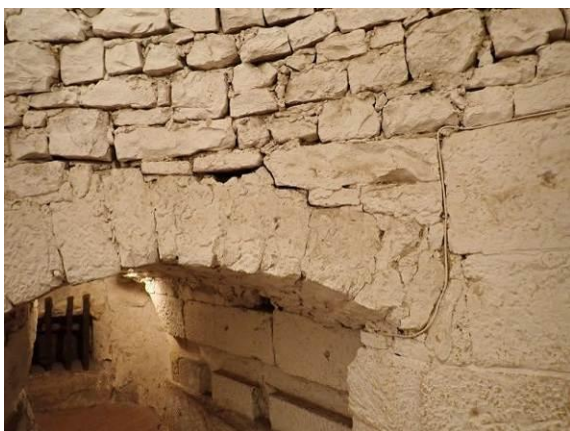
Rissbildung in den Nebentonnen
