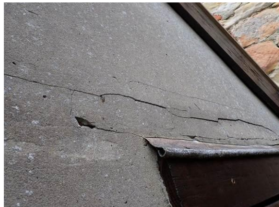
Gefügeschaden oberhalb des Türsturzes
