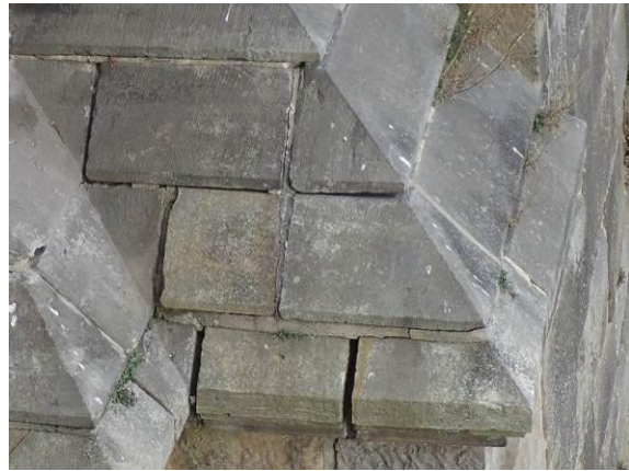
Gefügeschaden im Detail
