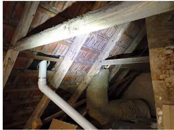
Fehlender Kehlbalken mit Wechsel
