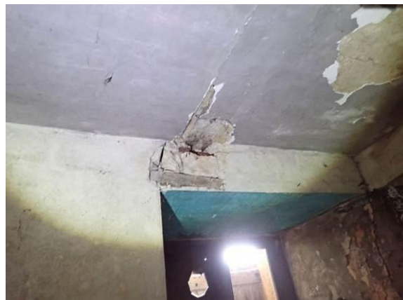
Weiteres geschädigtes Balkenauflager
