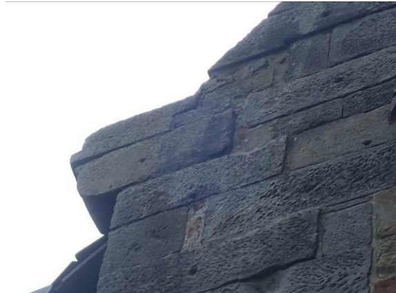
Schalenablösung im Detail
