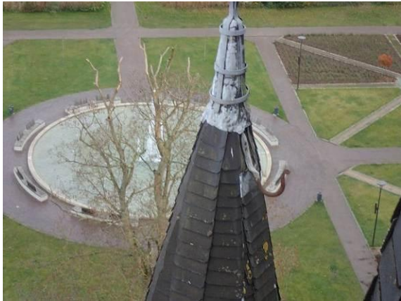
Gerissene Haube Turmspitze Nordwest
