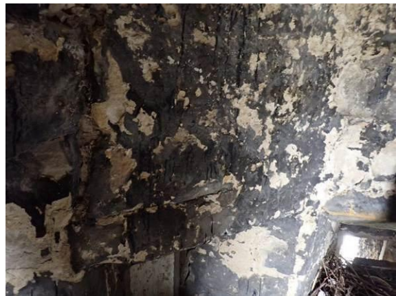
Dampfdruckschäden im Detail
