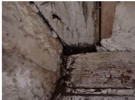
Schädigung am Knotenpunkt Südwest
