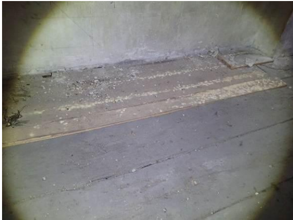
Befallsspuren, Decke im Südflügel
