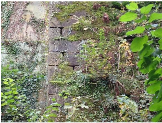
Gefügeschäden durch Wurzeldruck
