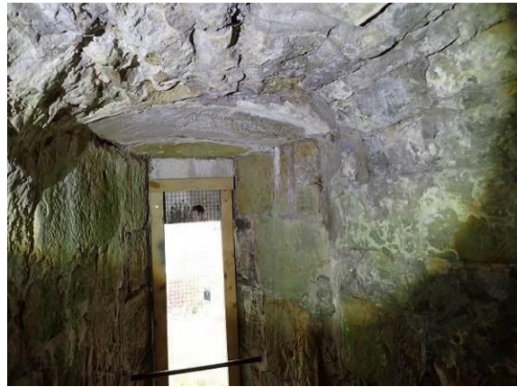
Bewuchs in einer Fenster niche
