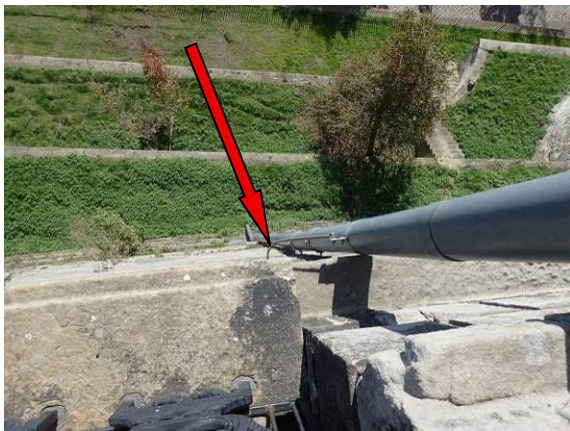
Verformung Außenschale Südwand
