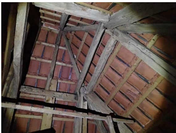
Fehlende Sicherung des Walms
