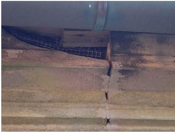
Fugenschaden am Traufgesims
