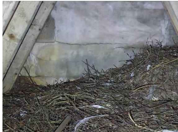
Verformung im Detail
