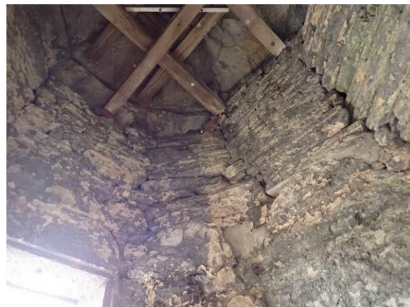
Zustand der Innenschale
