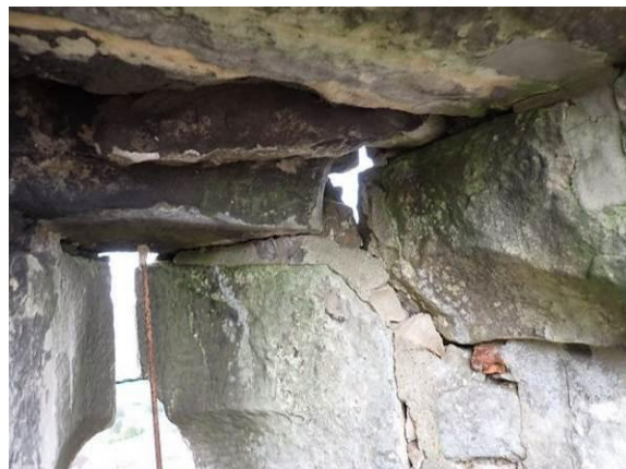
Gefügeschaden im Detail
