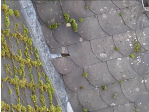
Gebrochene Platte, Kehle Nordost
