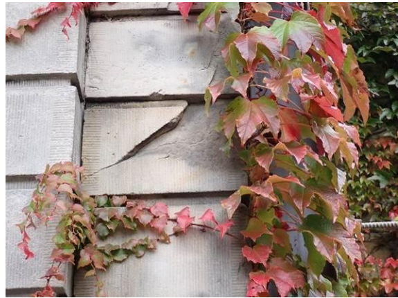
Rankenstränge im geschädigten Wandbereich
