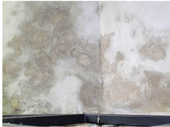
Feuchteschäden im Detail
