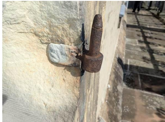
Schädigung im Detail
