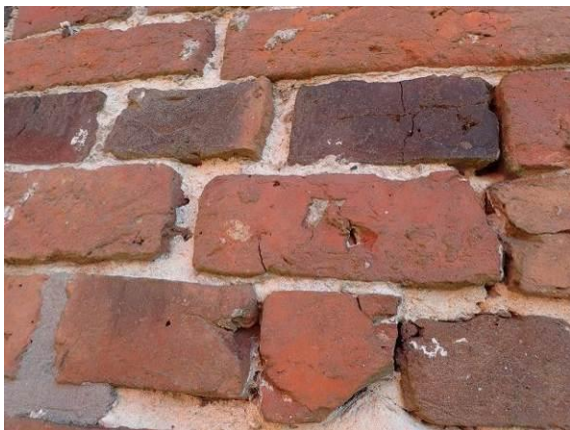
Geschädigte Verfugung Ziegelmauerwerk
