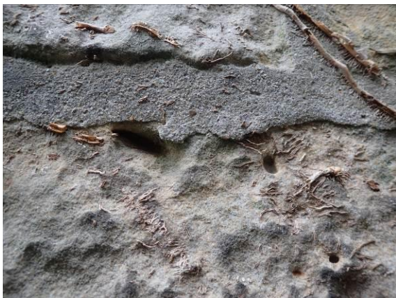
Separierung einer Zementfuge
