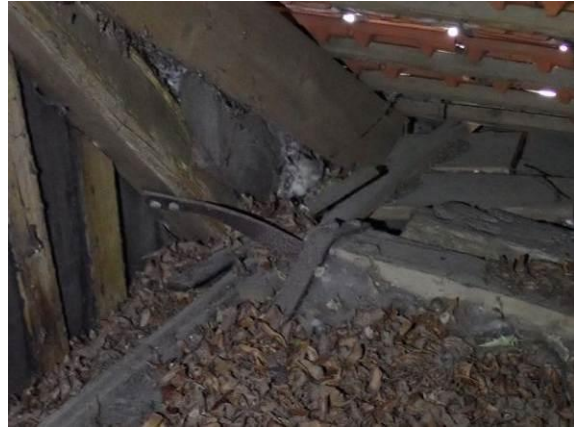
Sicherungsversuch der Sparrenschwelle
