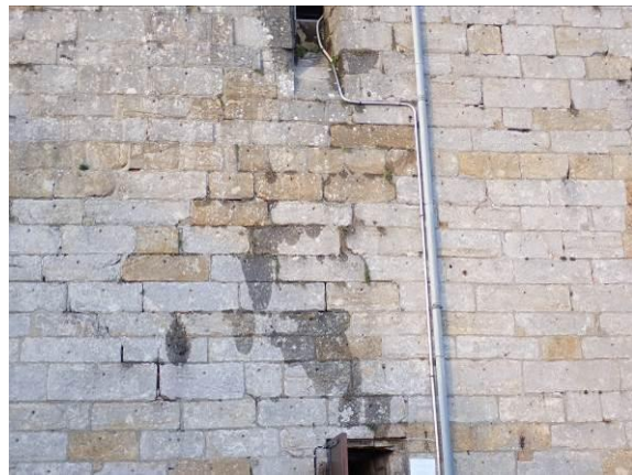
Wasseraustritt, Tage nach einem Regenereignis
