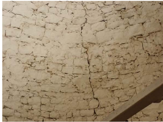
Rissbildung im Detail
