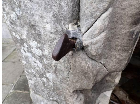
Korrosionssprengung im Detail
