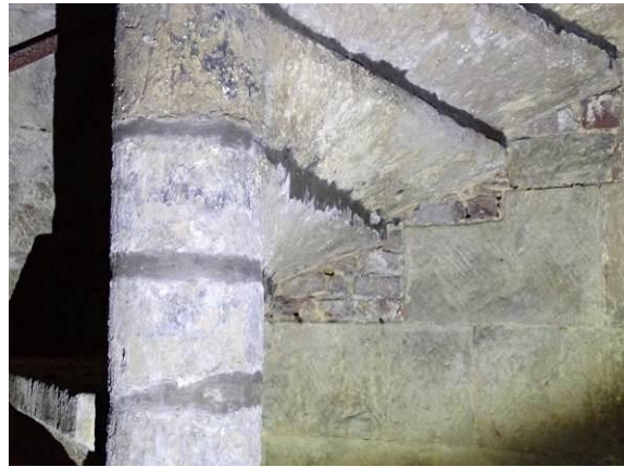
Schädigende Fugenreparatur im Detail
