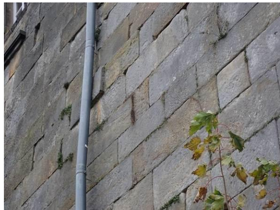
Gefügeschaden an der Südwestecke
