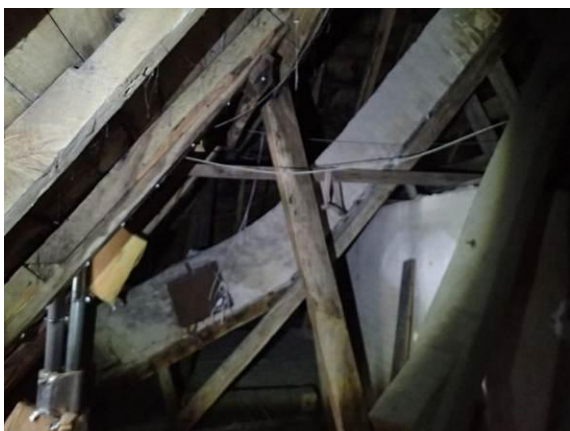
Verzogener Schornstein Südost
