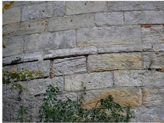
Geschädigte Verfüugung im Sockel
