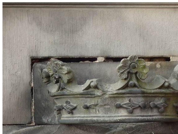
Zustand am Kragstein
