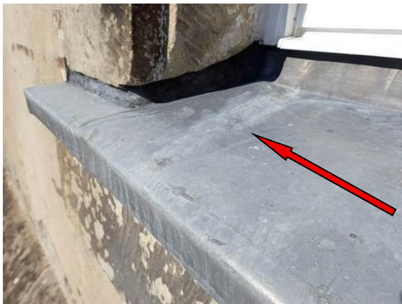
Aufwölbung Bleiabdeckung, Südfassade
