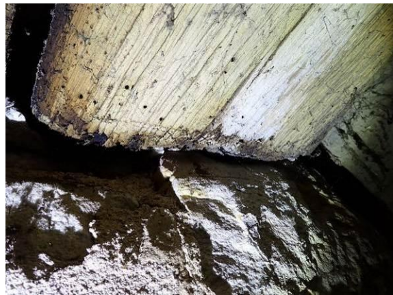
Befallsspuren am Balkenaufleger
