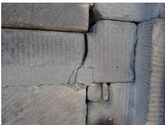
Rissbildung an der Traufwand des Erkers im Detail
