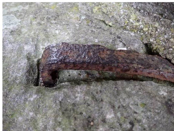
Zustand im Detail
