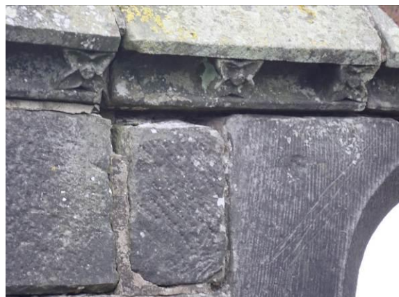
Gefügeschaden im Detail
