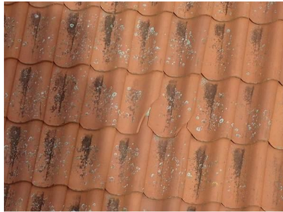
Ausbrüche im Detail
