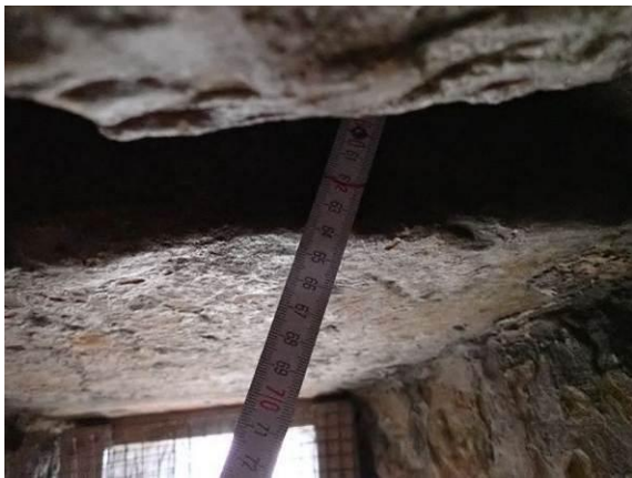
Fehlstellen im Mauerwerkskern
