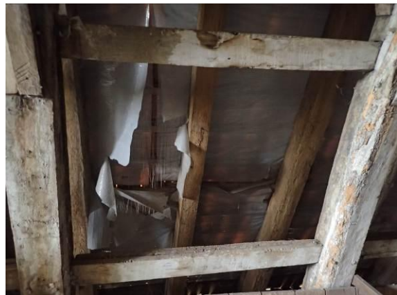
Undichtigkeiten im Detail
