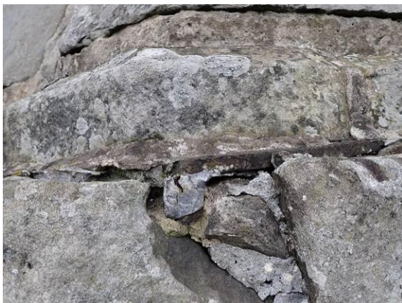
Korrodierte Klammer in einer Steinkuppel
