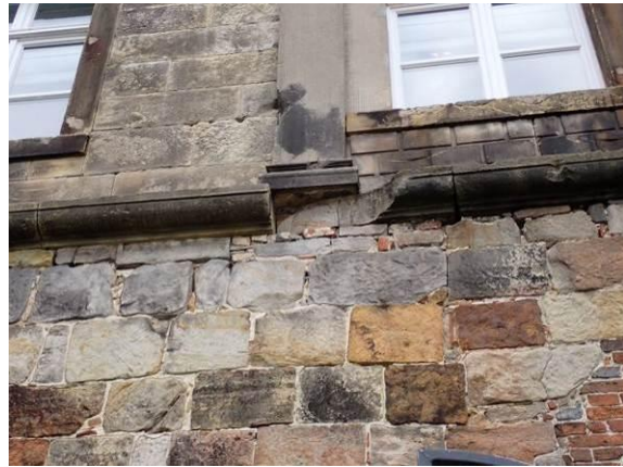
Fugenschäden im Erdgeschoss
