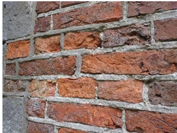
Zustand im Detail
