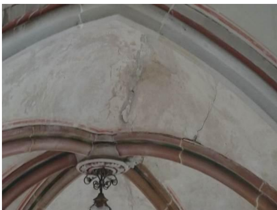
Verformung und Rissbildung im Detail
