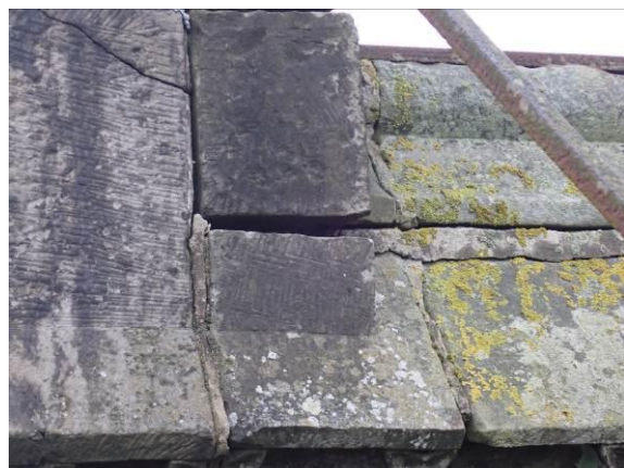
Gefügeschaden durch Korrosionssprengung
