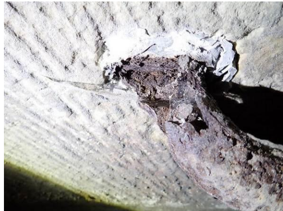
Zustand im Detail
