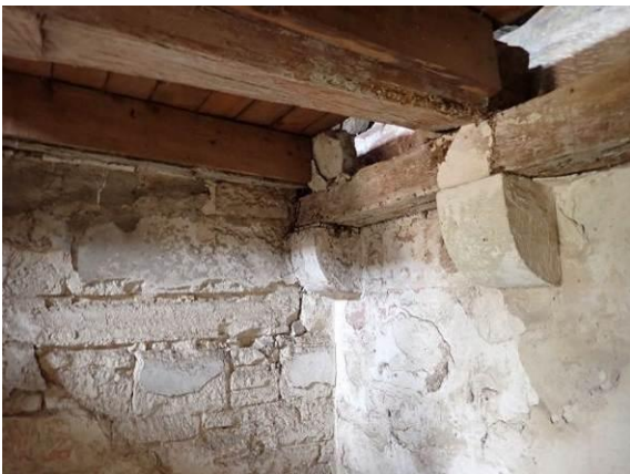
Auflagerung Deckenscheibe auf Sandsteinkonsolen
