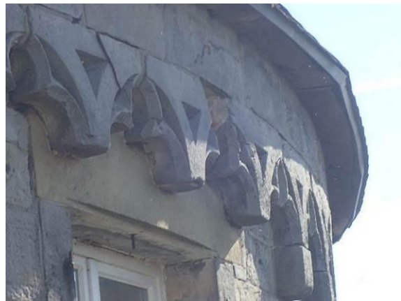
Zustand am Traufgesims
