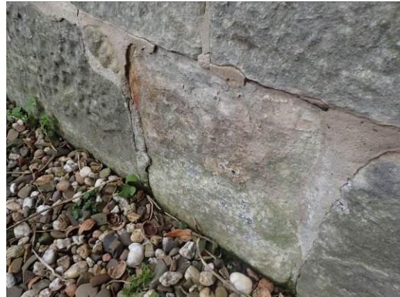
Oberflächenschaden durch Verkrustungen
