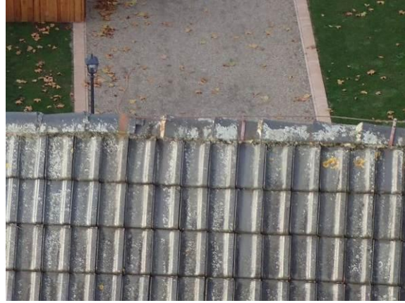
Verformte Fangleine am ehemaligen Kassenhaus
