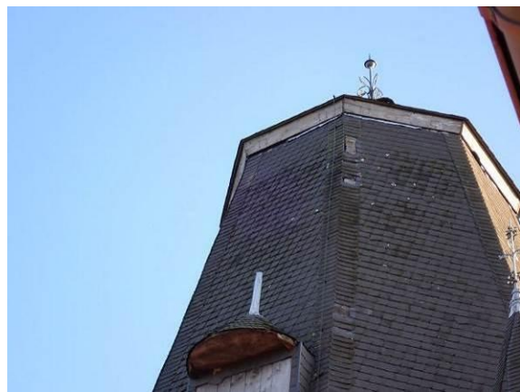
Bewuchs auf der Dachhaut
