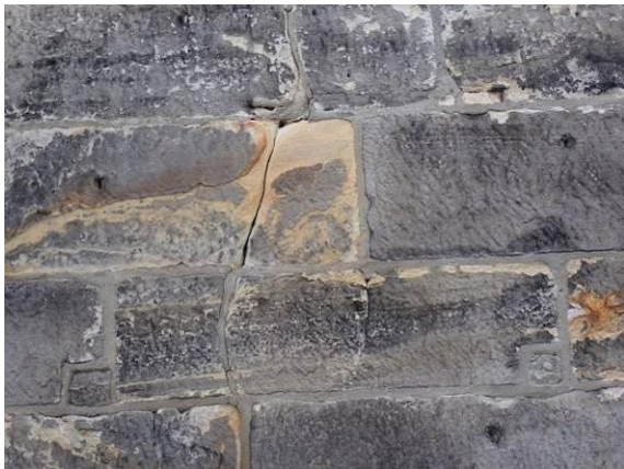
Oberflächenverlust durch Dampfdruckschäden
