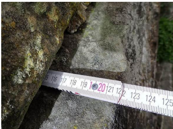
Hohlräume im Kernmauerwerk
