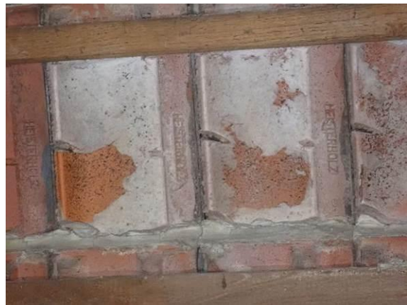
Verkrustung der Ziegelunterseiten
