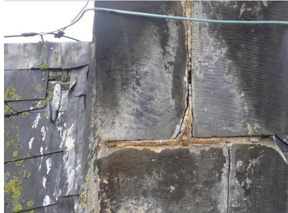
Zustand im Detail
