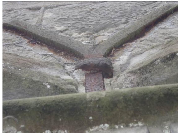
Zustand im Detail
