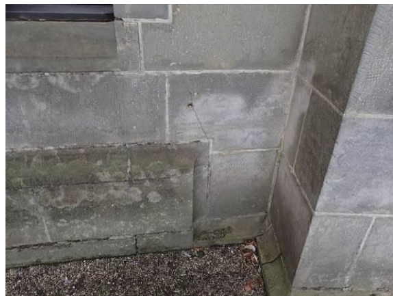
Zustand im Detail
