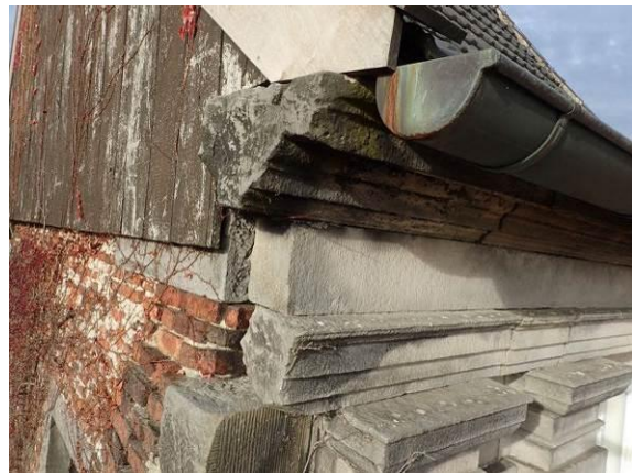
Verformung Traufgesims Ost
