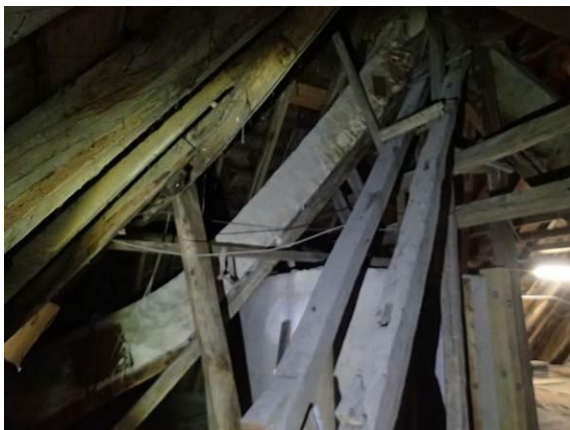
Lastkonzentration durch verzogene Schornsteine
