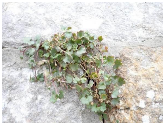
Bewuchs im Fugenbereich
