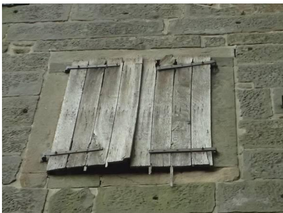
Weitere geschädigte Klappläden
