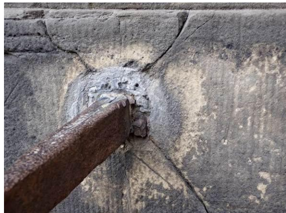
Zustand im Detail
