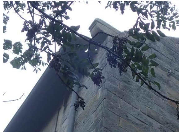
Fehlstelle in der Dachhaut
