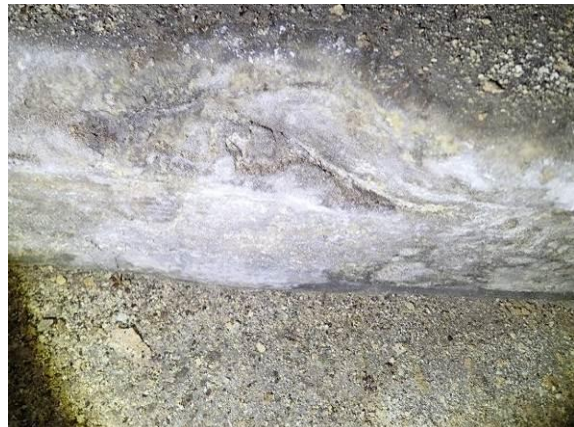
Kantenausplatzung im Detail
