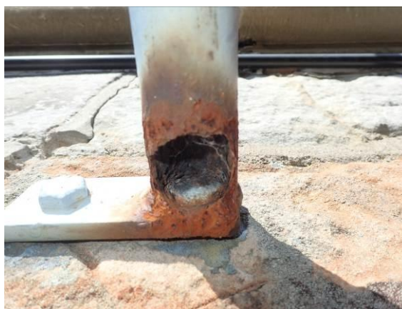
Zustand im Detail
