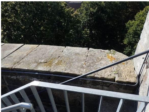
Geschädigte Fugen der Mauerkrone
