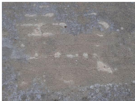
Rissbildung durch Mauerwerksverspannungen
