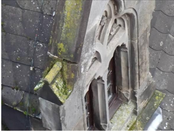
Bewuchs auf der Giebelabdeckung, Gaube Ost
