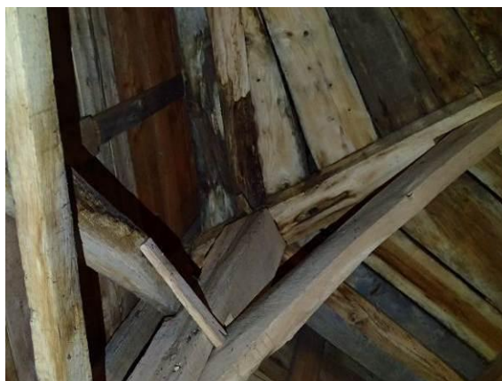
Schäden am Zwischenrahm
