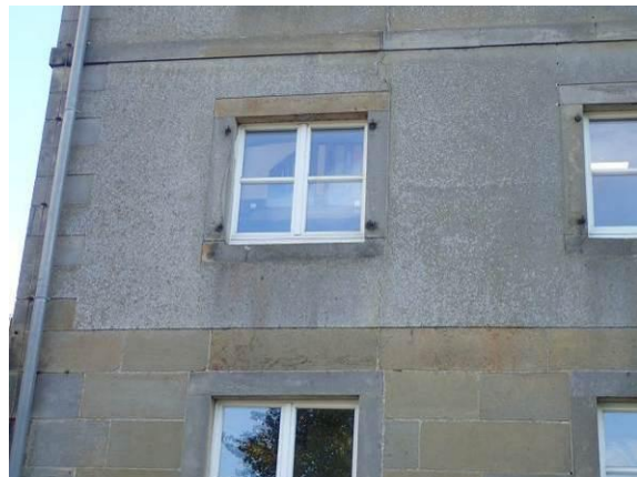
Rissbildung im Fensterachsenverlauf
