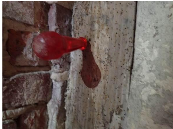
Zustand im Detail
