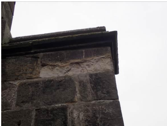
Steinschaden durch Materialabbau
