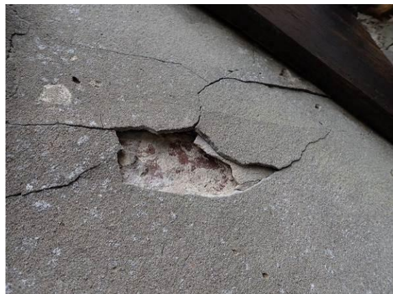
Schädigung im Detail
