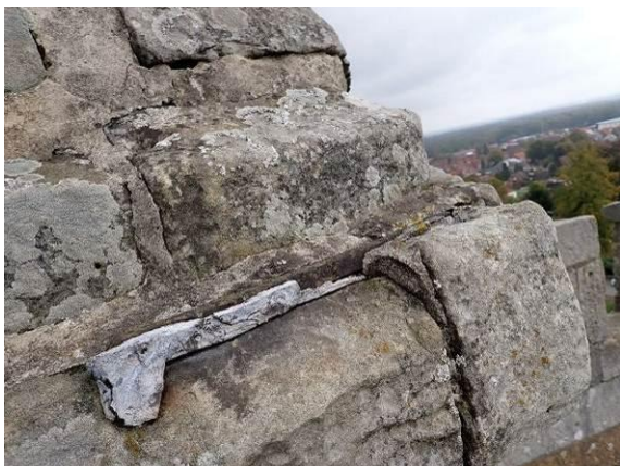
Gefügeschaden in der Außenschale
