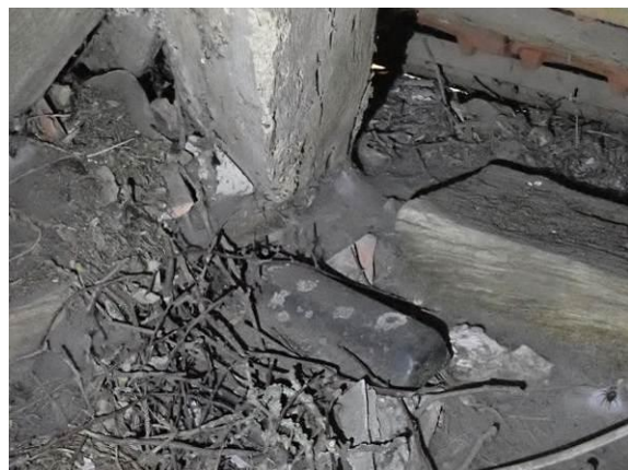
Verformung im Eckenbereich
