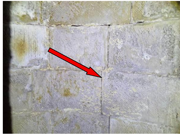
Rissbildung im Fugenverlauf
