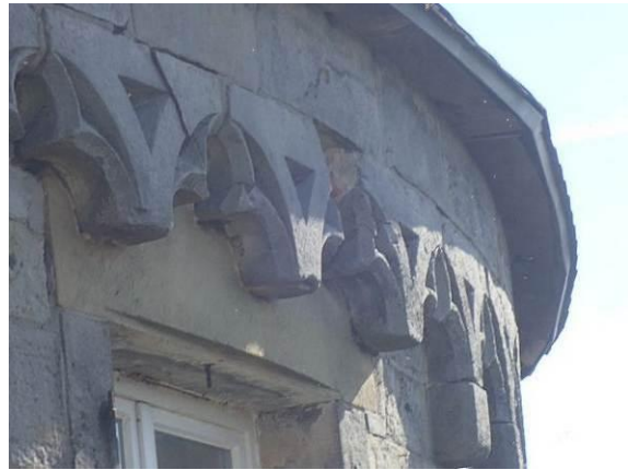
Zustand im Detail
