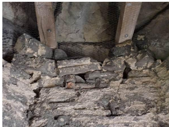
Gefügeschaden im Detail
