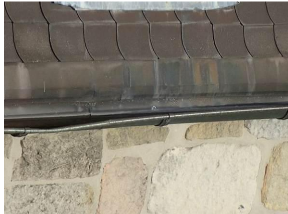
Verformung im Detail
