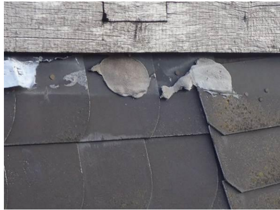
Zustand im Detail
