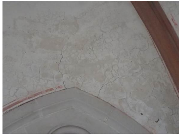
Feuchteschäden in den Kappensegeln
