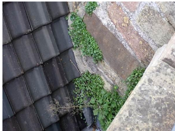
Zustand im Detail
