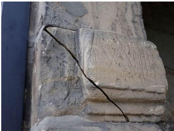
Bruch aus Überbeanspruchung
