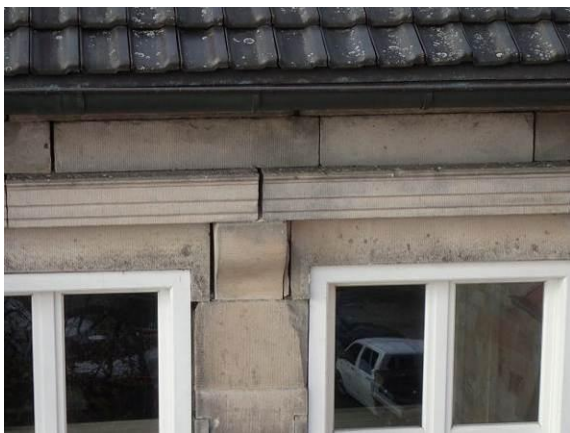
Geschädigte Verfugung Werksteinmauerwerk
