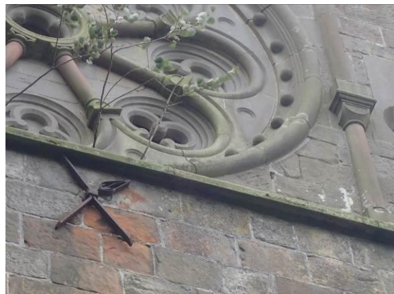
Bewuchs auf einem Kranzgesims, Nordfassade
