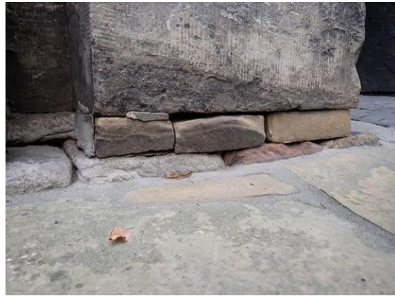
Zustand im Lisenen Fundament
