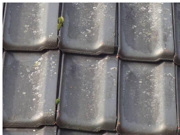
Verformung der Dachhaut
