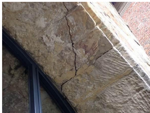
Rissbildung im Laibungsbereich
