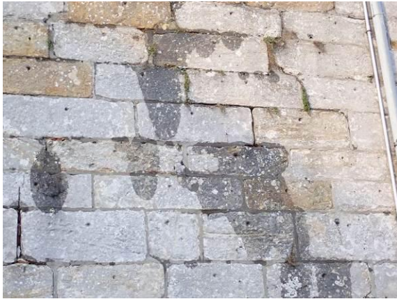
Wasseraustritt aus den Fugen
