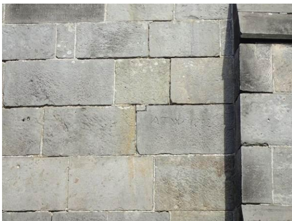
Geschädigte Fugen der Westfassade
