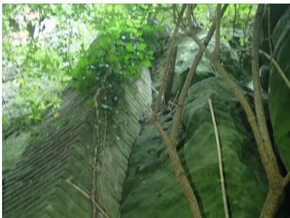
Biogener Befall, Sockel Nord
