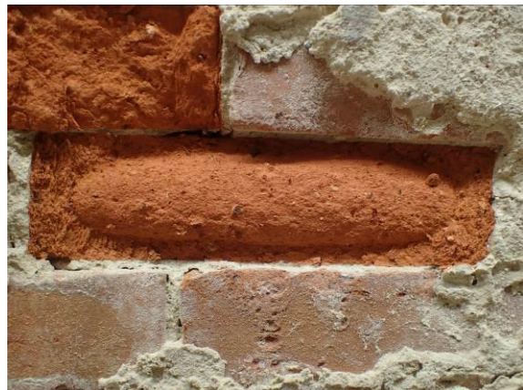
Schädigung im Detail
