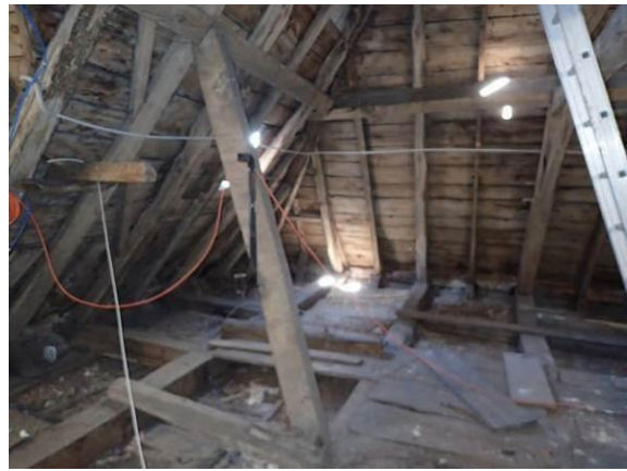
Fehlende Eckabstützungen der Walmpfette West
