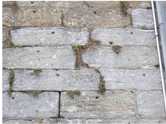
Rissbildung im Fugenverlauf
