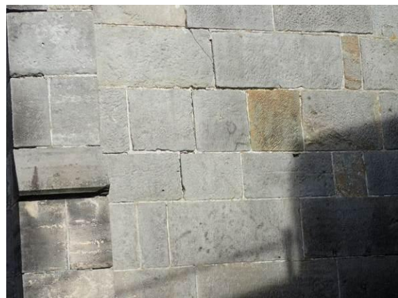
Rissbildung im Detail
