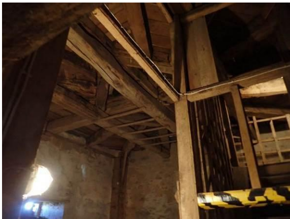
Teilansicht untere Turmhelmdecke
