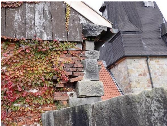
Gefügeschaden Anschluss zur Traufe Ost
