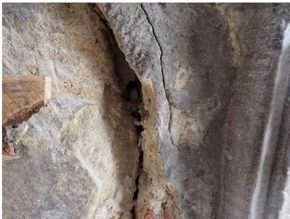
Verformung im Detail
