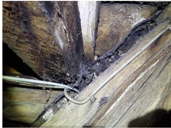
Feuchteschaden im Detail
