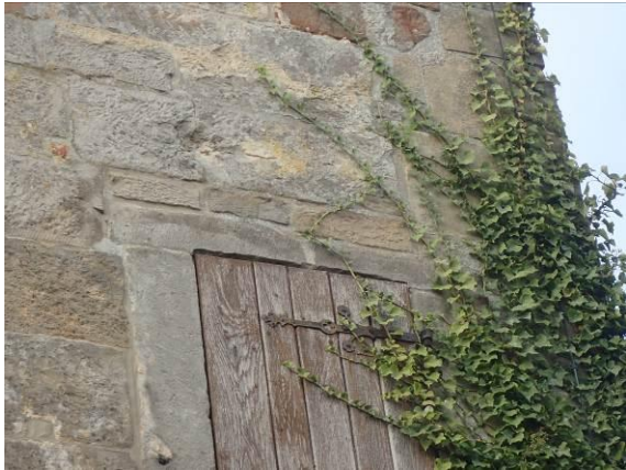
Efeubewuchs Nordostecke, Nordflügel
