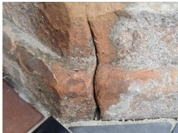
Rissbildung im Detail
